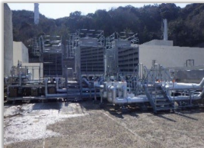
個別冷却装置冷却塔
