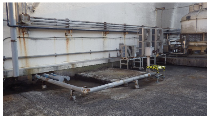
給湯設備膨張タンク（解体後）
