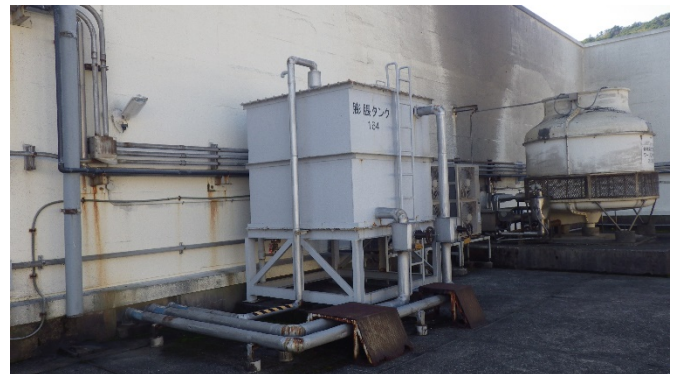
給湯設備膨張タンク（解体前）
