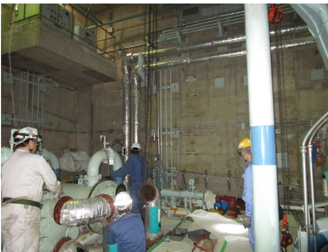
冷却器の点検(2)
