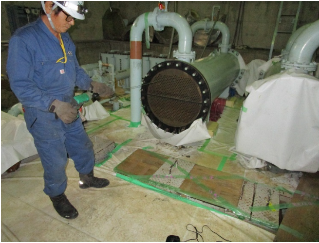
冷却器の点検(1)
