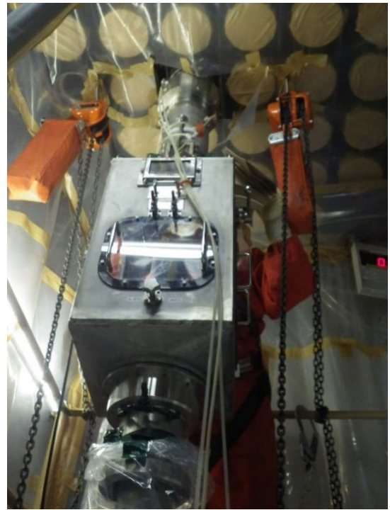
写真 3. 炉下部に設置された試料採取装置
