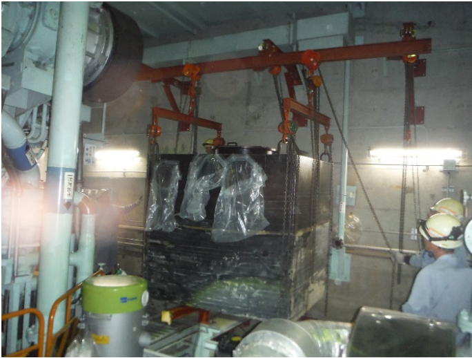
潤滑油サンプタンクの点検
