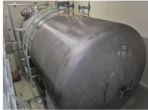
(樹脂交換タンク)
