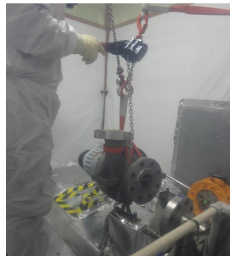
解体撤去工事状況 (汚染を内包するブースターポンプ本体の 解体撤去)
