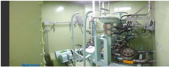
ブースターポンプ及び周辺機器・配管外観
