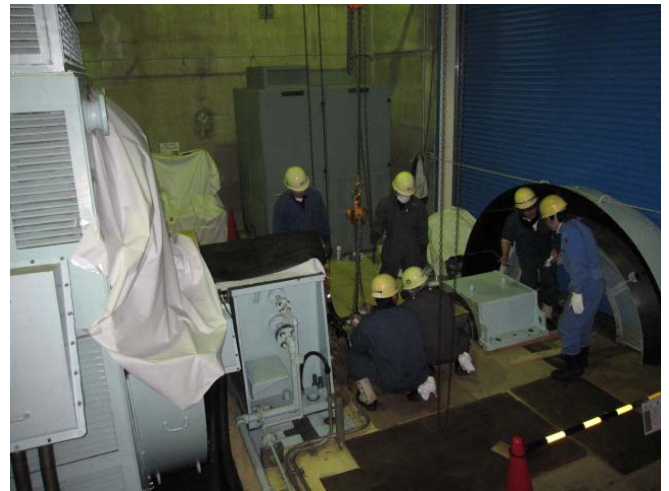
非常用ディーゼル発電機軸受点検状況
