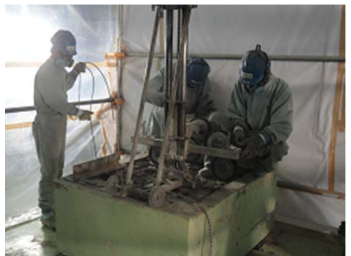
乾式ダイヤモンドワイヤーソーによる基礎コンクリート切断作業
