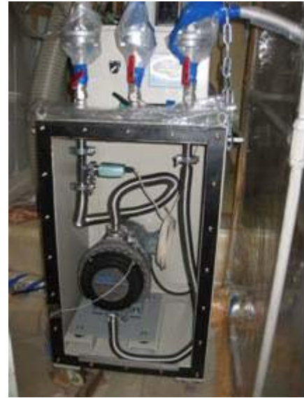
加熱真空引きに使用する真空ポンプ
