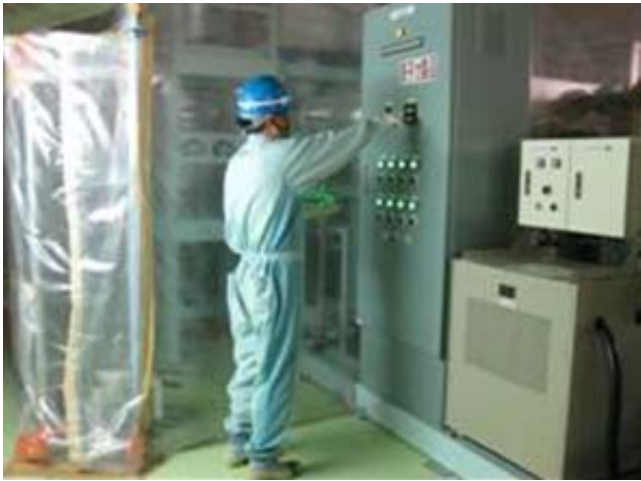
トリチウム除去装置の運転状況
