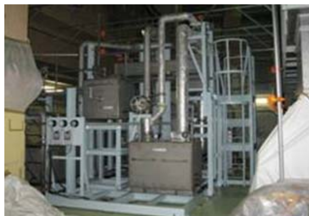
トリチウム除去装置の外観(グリーンハウス設置前)
