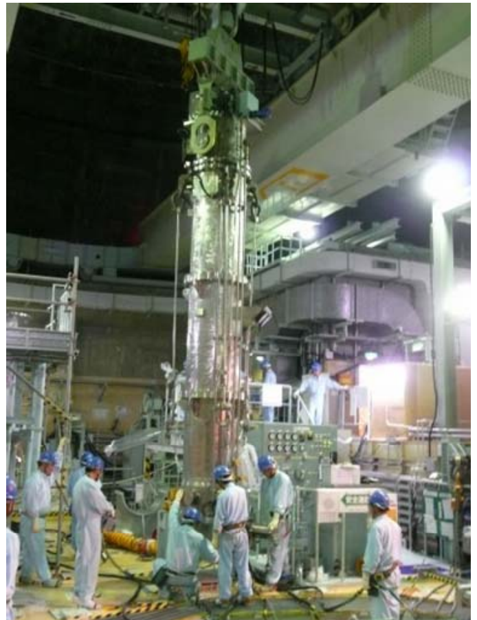
制御棒取出し後、燃料交換プールに移送中の様子
