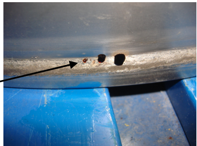
写真4 当該300Lドラム缶の背面底部の点状の漏えい箇所
