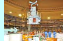
1次冷却系主循環ポンプ点検
