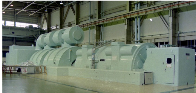
タービン発電機（タービン建物3階）
