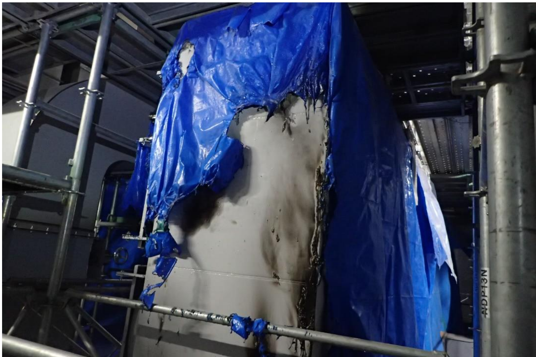
ブルーシートの焼失状況
