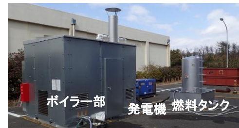
高放射性廃液の漏えい液回収機能の維持(可搬型蒸気供給設備)
