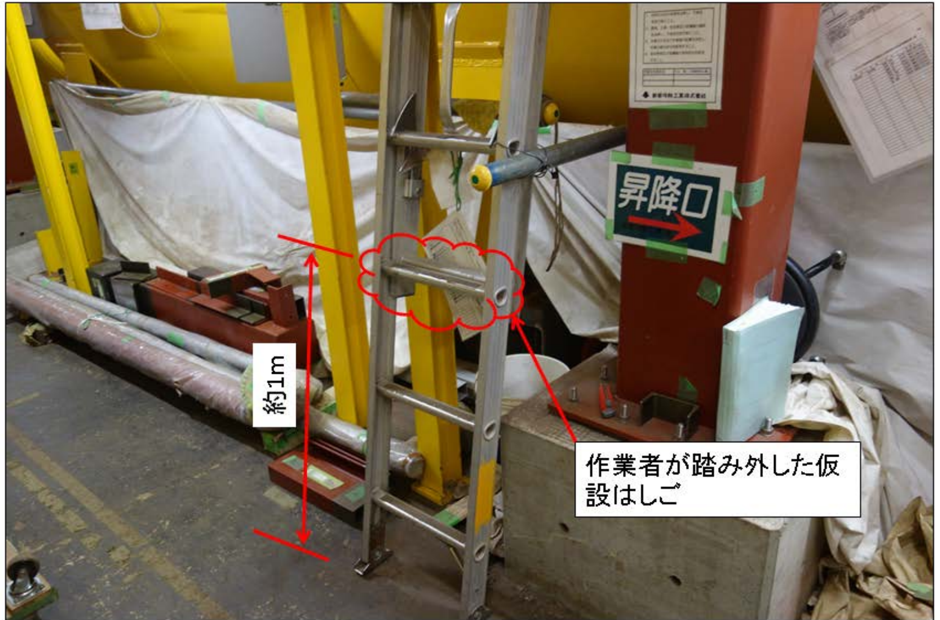
作業者が踏み外した仮設はしご写真
