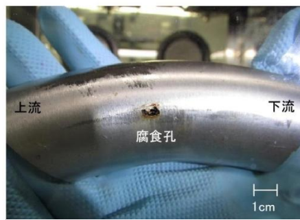
W004 配管外側底面の汚染部(腐食孔)
