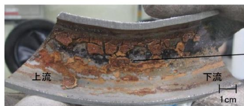
W004 配管底面汚染部(腐食孔)の内表面
