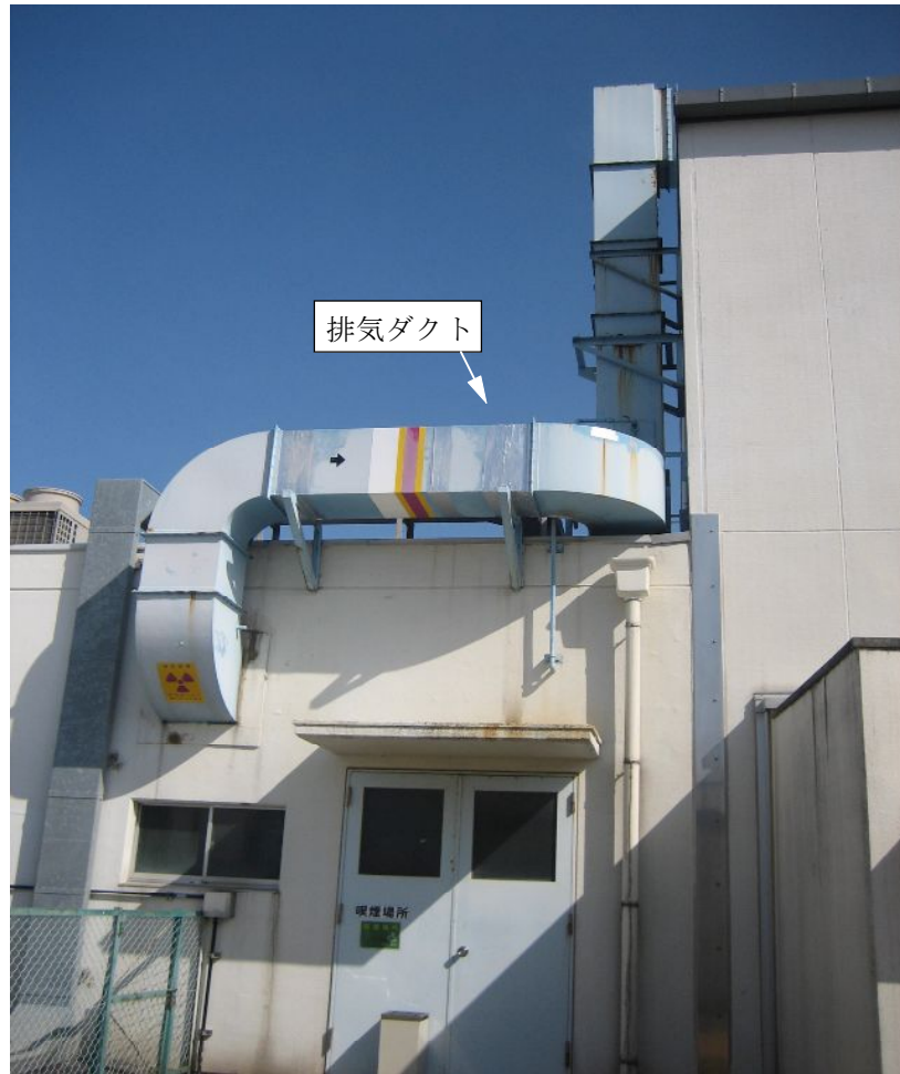
屋外に設置されている排気ダクト部の写真 (A視)
