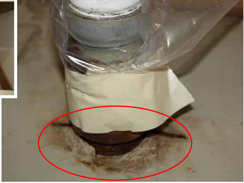
塩化ビニルシートの剥がれによる排水配管との隙間
