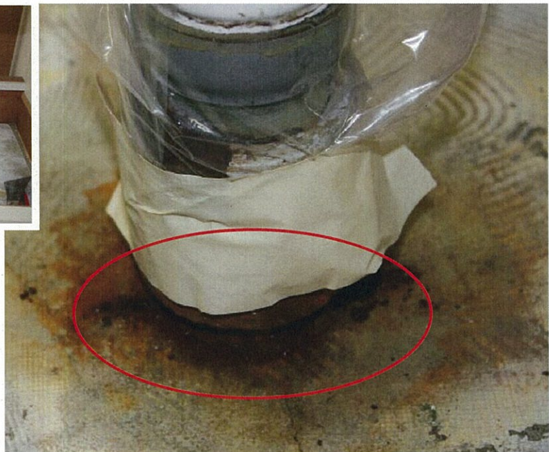
排水配管周囲のしみ (塩化ビニルシートを剥がした後)
