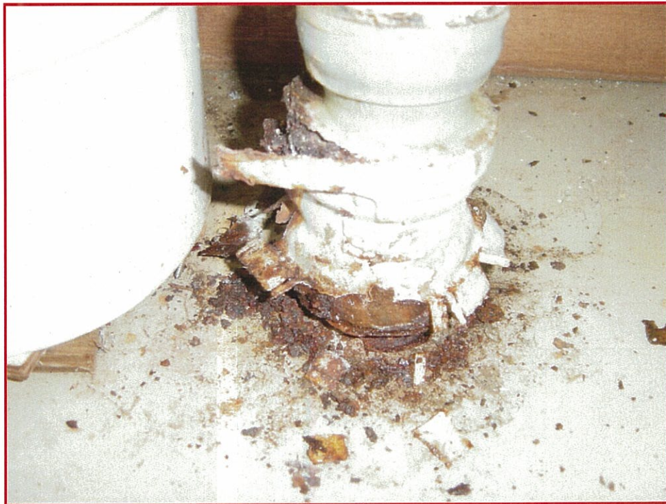
図6 3階試験室2 (管理区域) 流しの排水配管接続部
