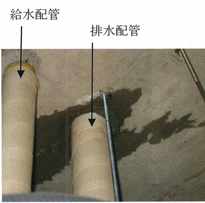
2階天井のにじみ箇所
