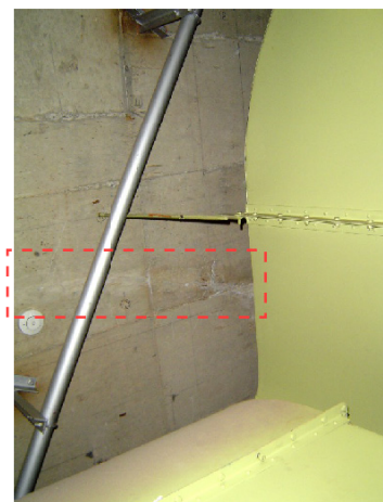
⑥ ひび割れ (w=0.25mm)
