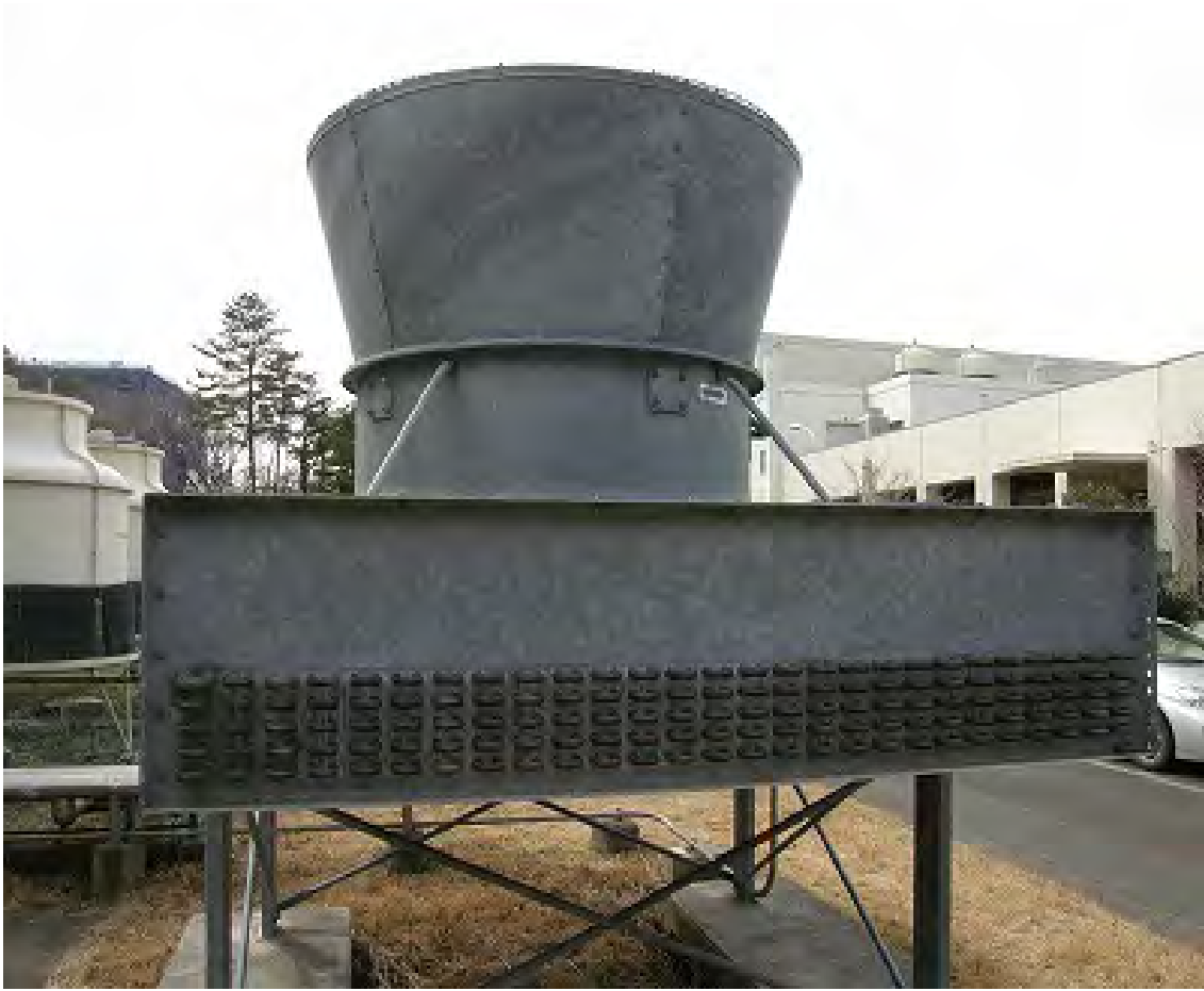
ラジエータ設備
