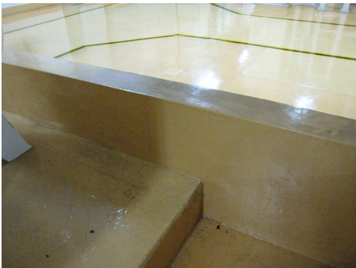
写真 16 第 2 排風機室 第 2 試験セル排気シールポット液堤の亀裂(2)
