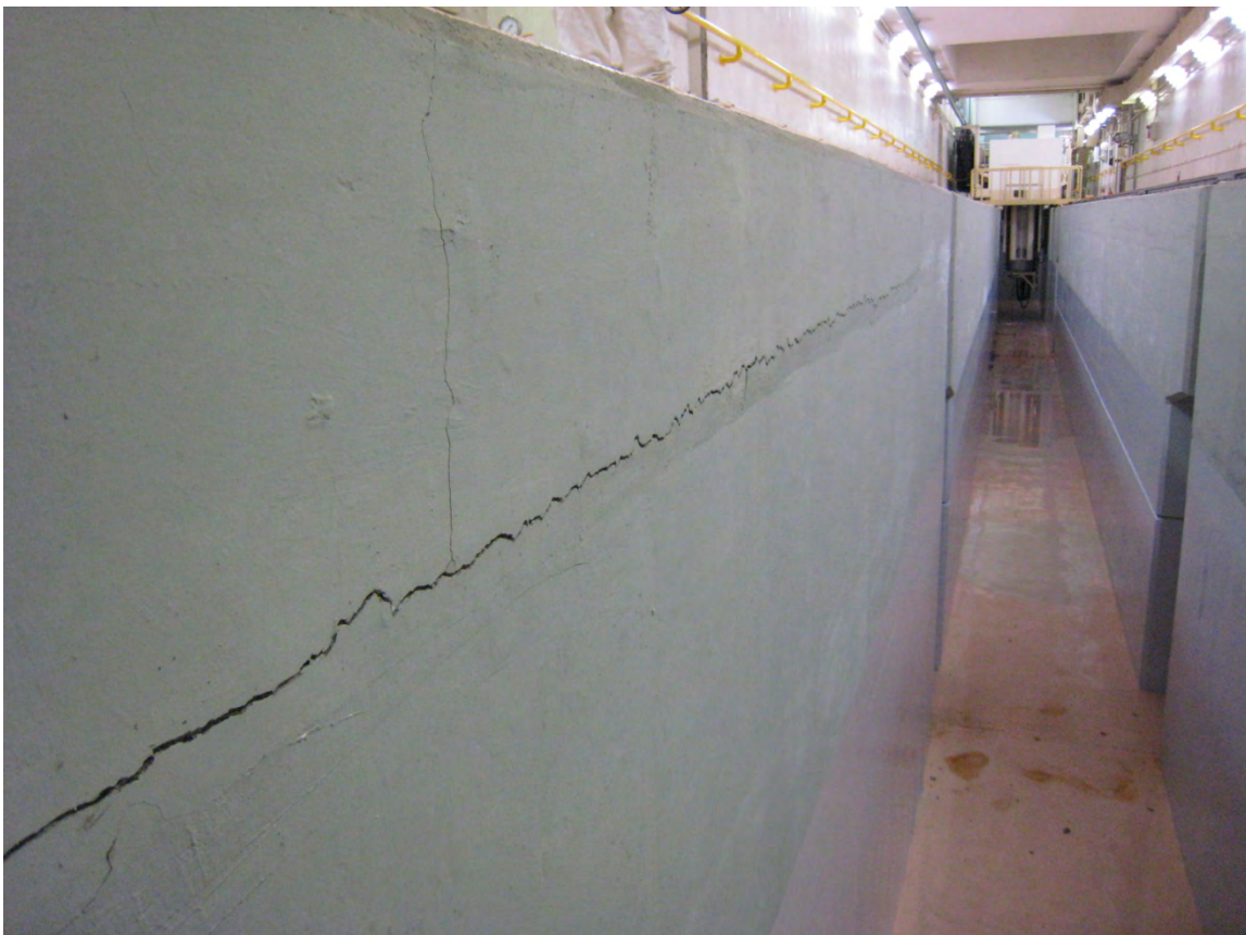
写真 19 地下1階キャスクコリダ側壁の亀裂
