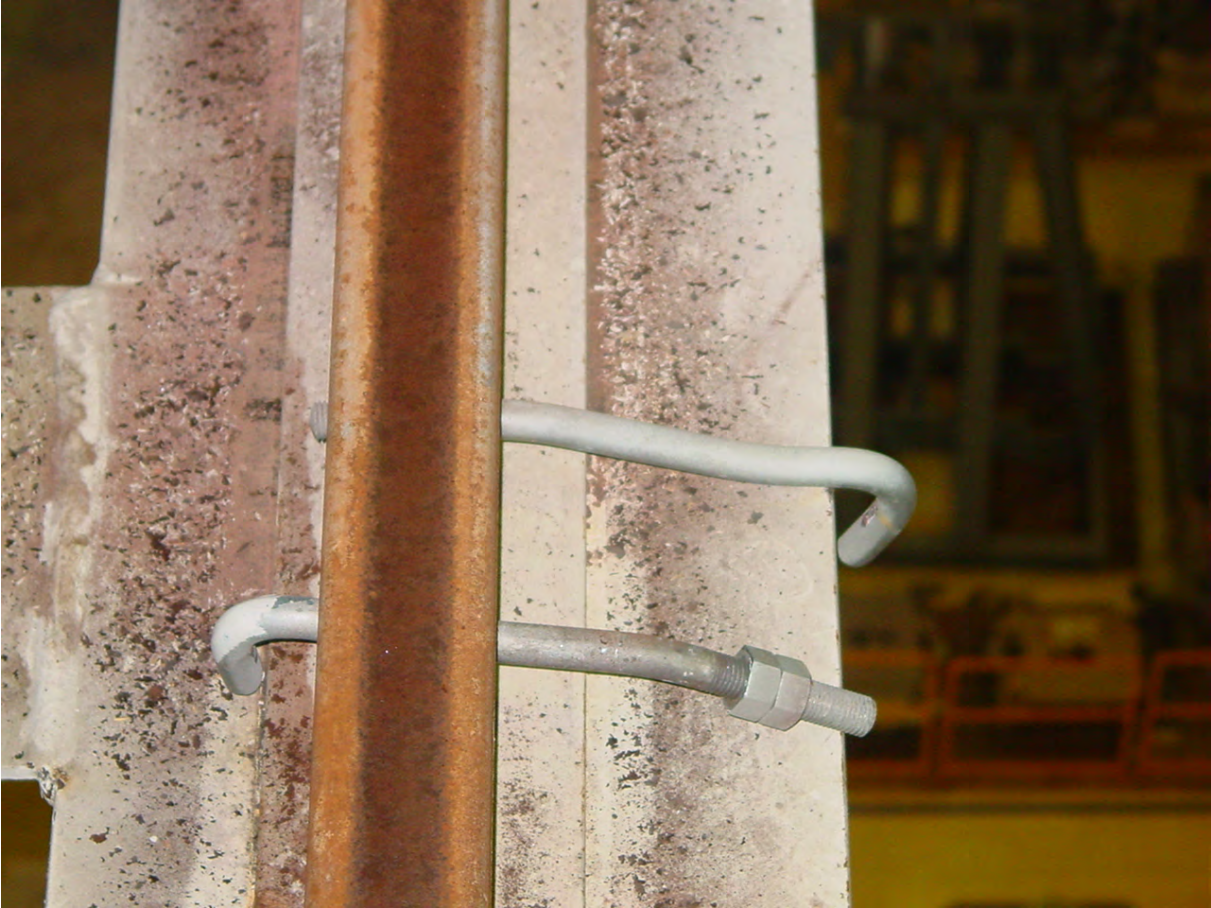
写真6 レール留め金具の変形
