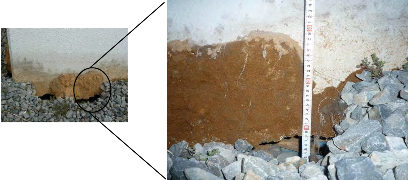
30~40cm 程度の地盤沈下
