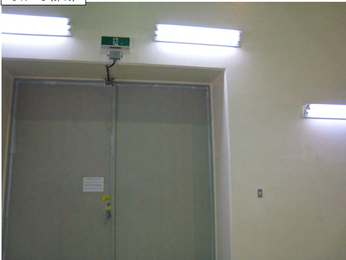
写真 8 第 2 補修室物品搬出口右上の亀裂
