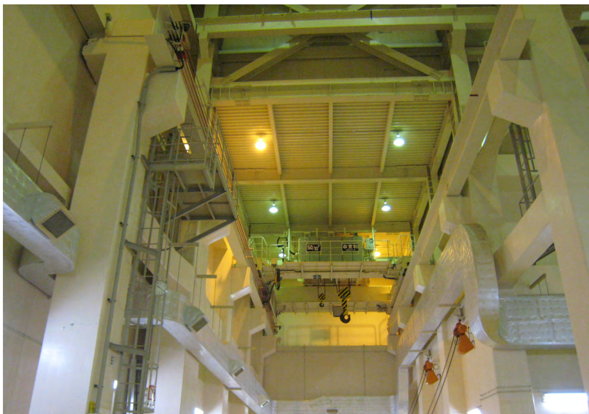
写真4 サービスエリアクレーン (50/10 t)支柱損傷状況 (全景)
