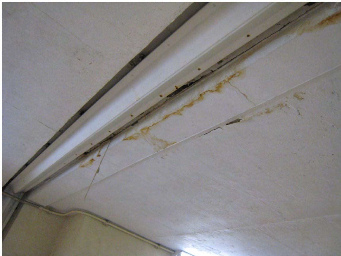
写真 20 地下1階キャスクコリダ天井の損傷 (FMF-「常陽」境界部)
