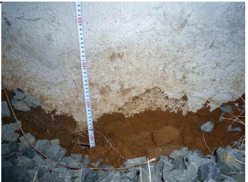
40~50cm 程度の地盤沈下
