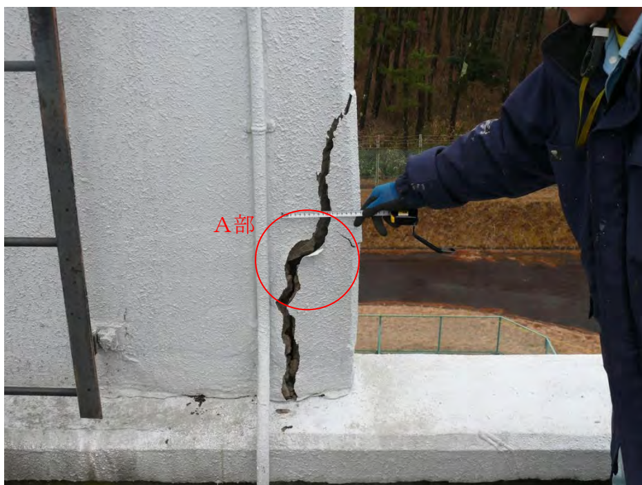
ひび割れの状況
