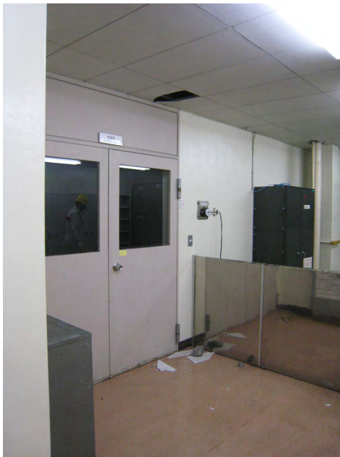
写真 21 ホット更衣室天井の破損 (実験室入口)
