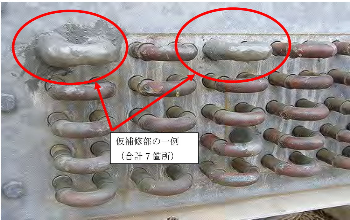
ラジエータファン銅管破損部の仮補修箇所の一例
