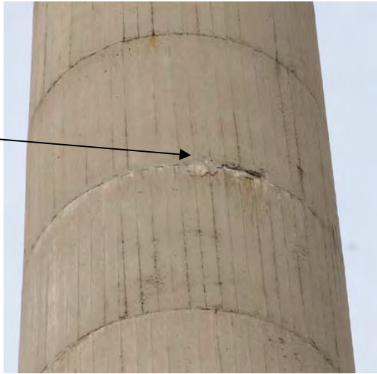
コンクリート剥離部
