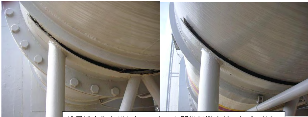
排風機室集合ダクト～スタック間排気管サポートズレ状況
