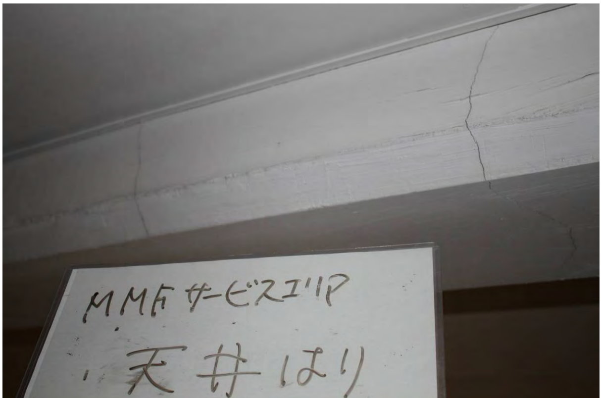
MMF サービスエリア天井梁のヒビ
