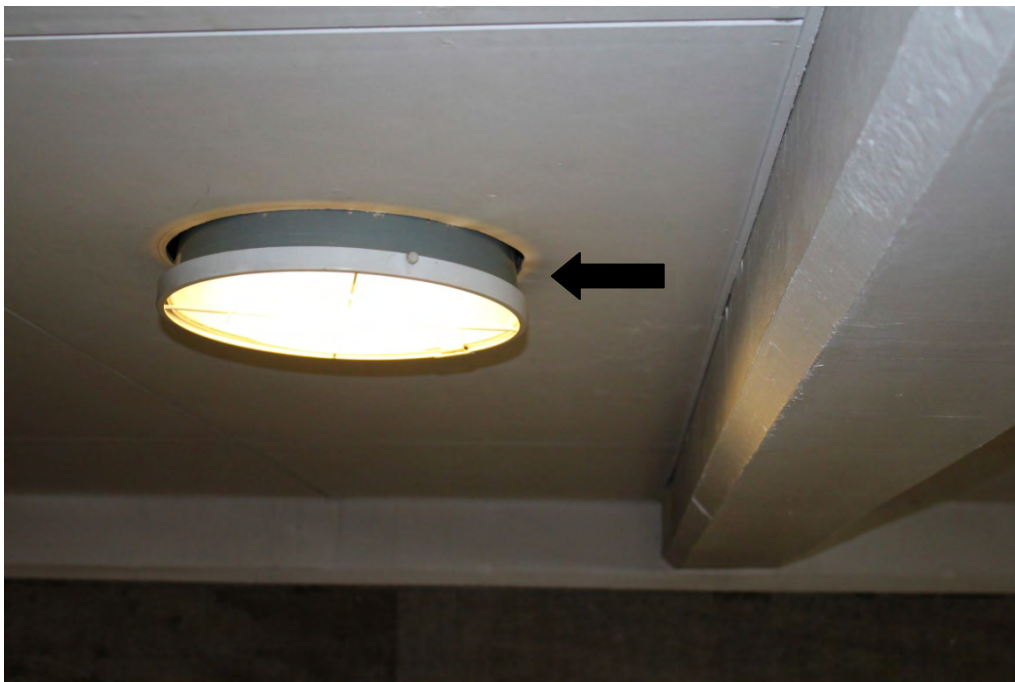
天井の隙間（矢印部）が大きく開いている箇所がある。
