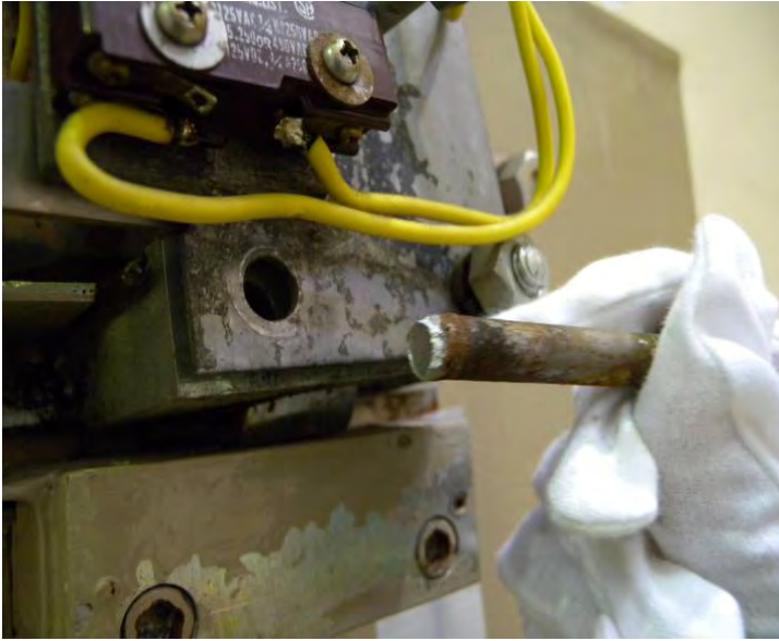
セル背面扉機械錠の破損
