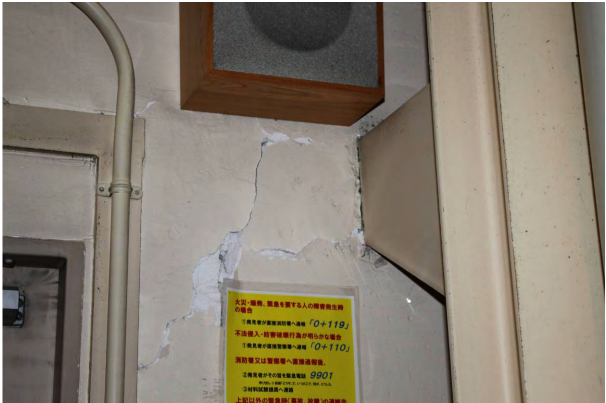
MMF サービスエリア南側壁のヒビ
