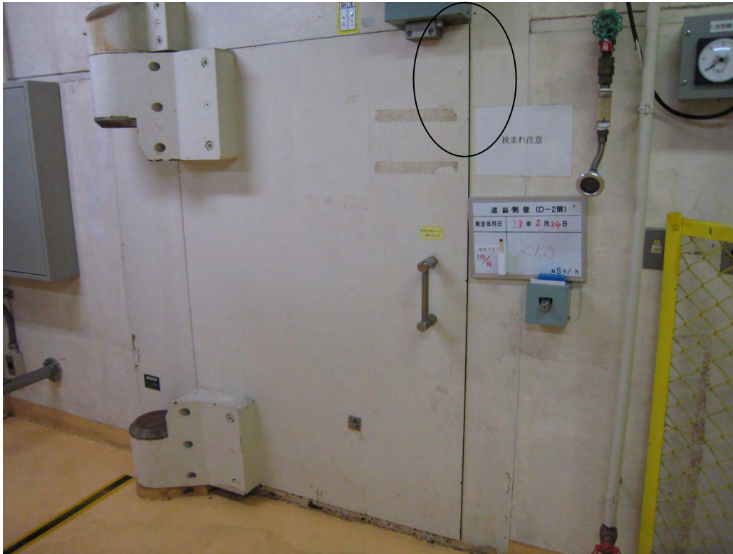
セル遮へい扉外観
