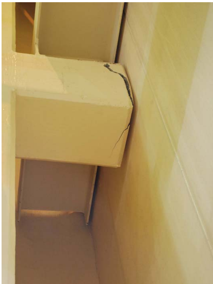
写真3 サービスエリアクレーン (50/10 t)支柱損傷状況
