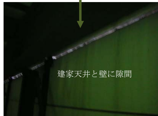
「常陽」メンテナンス建家の隙間発生状況
