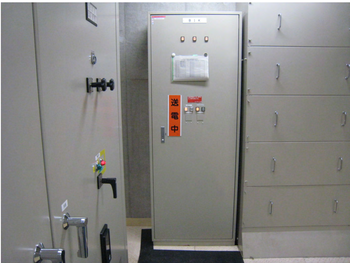
写真2 放管設備ダストサンプラ受電盤の不良
