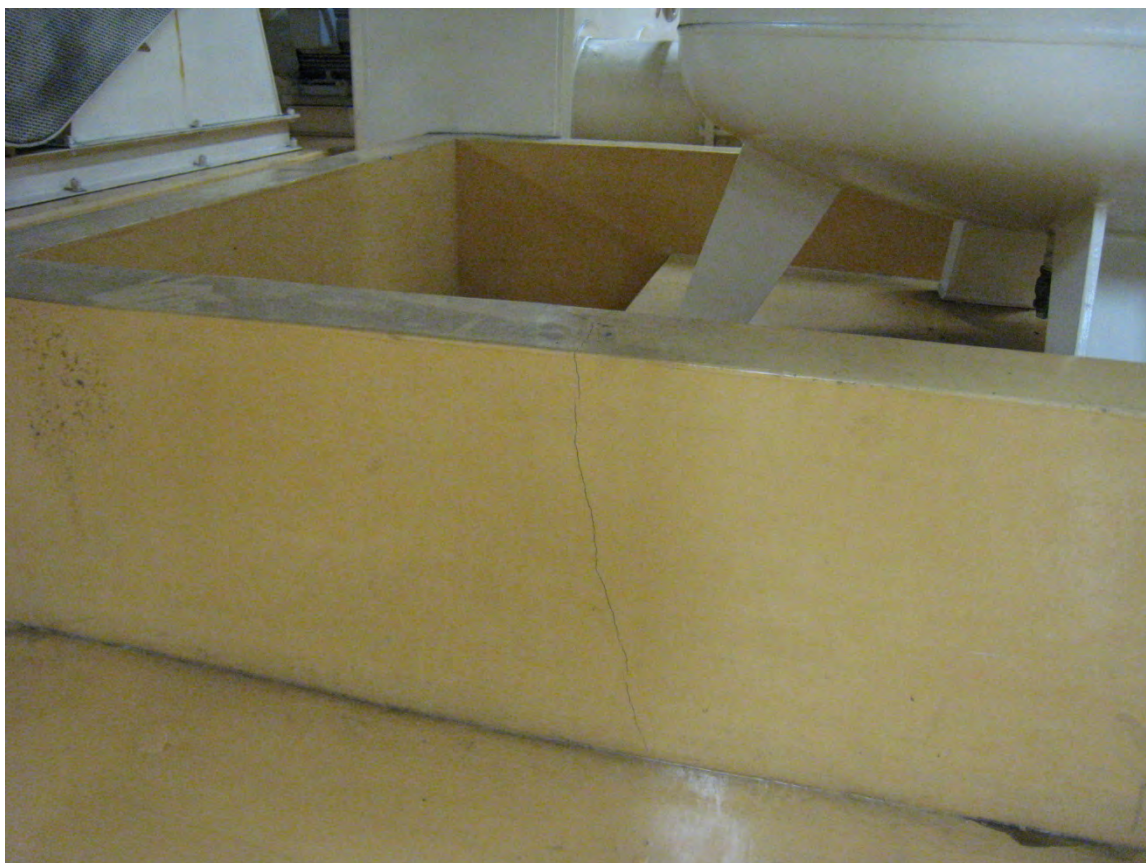
写真 15 第 2 排風機室 第 2 試験セル排気シールポット液堤の亀裂(1)
