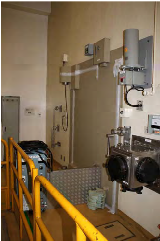
MMF-2 No.1セル背面扉 (錘、つかえにより開放を防いでいる。 目張り実施済み。)
