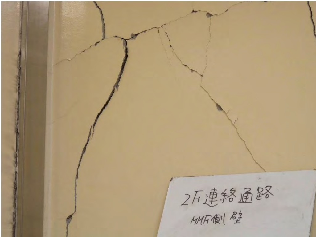
MMF-MMF-2 連絡通路壁のヒビ
