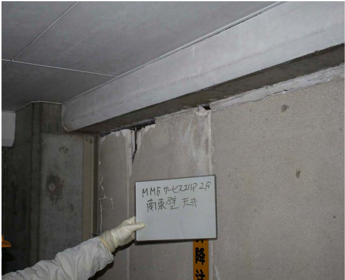
MMF サービスエリア南側壁のヒビ
