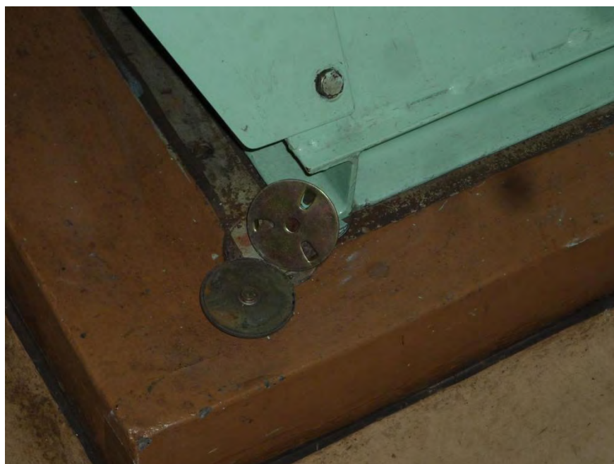
地震により移動した送風機
