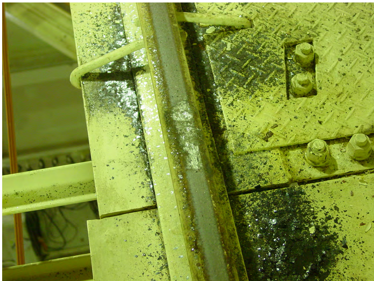
写真5 クレーンレール架台のずれ
