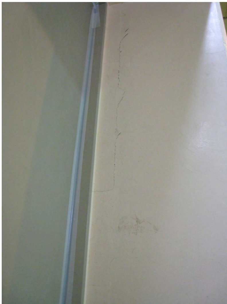
写真 9 第 2 補修室物品搬出口右上の亀裂 (拡大)
