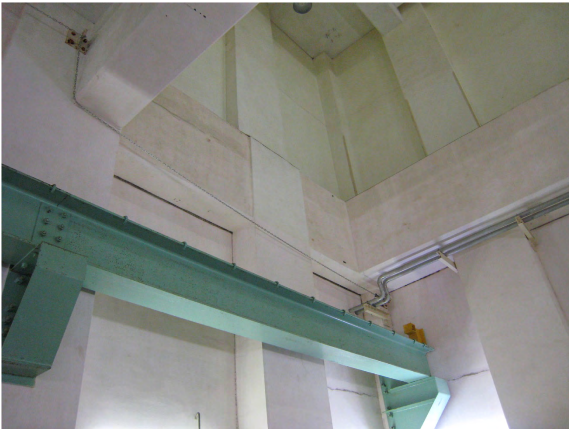
写真 17 地下 2 階キャスク保管室壁面と梁との隙間
