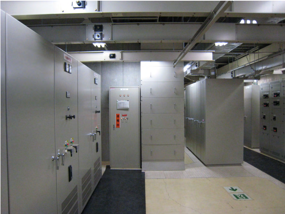
写真1 放管設備ダストサンプラ受電盤の不良
