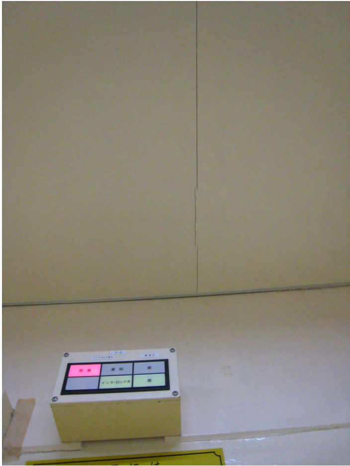
写真 22 地下 1 階第 2 ホット更衣室 天井部の亀裂
