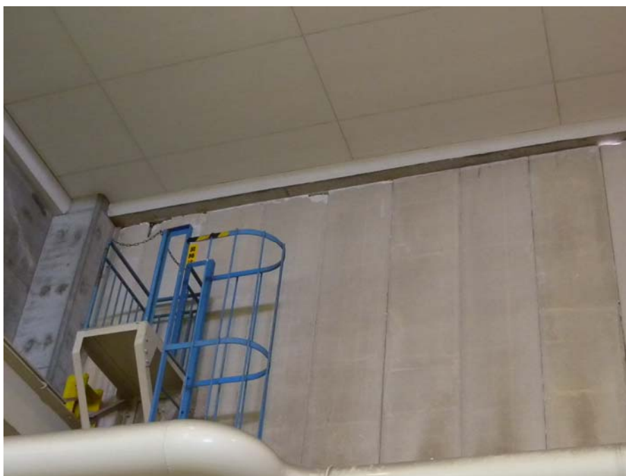
MMF サービスエリア 2 階上部の南側壁（き裂及び隙間）
