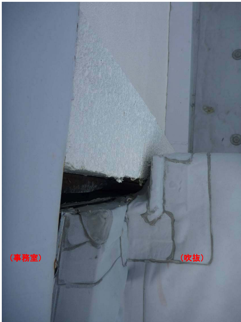
写真 12 屋上（4階方向を見下ろす）（被害箇所⑫）
