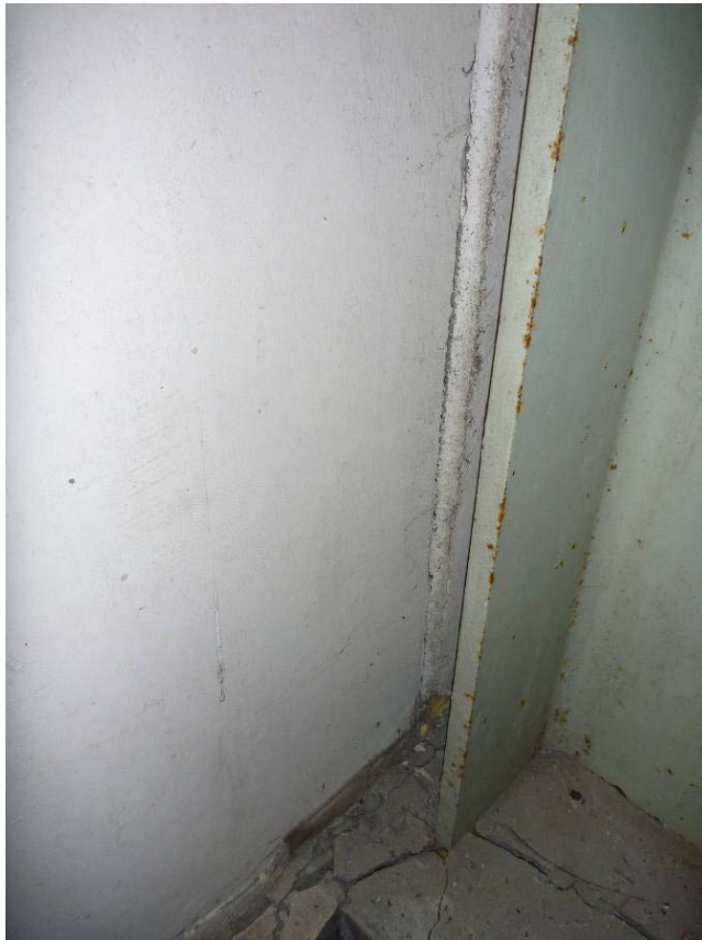
写真 11 管理機材倉庫（工学試験室側壁（南西部））（被害箇所①）
