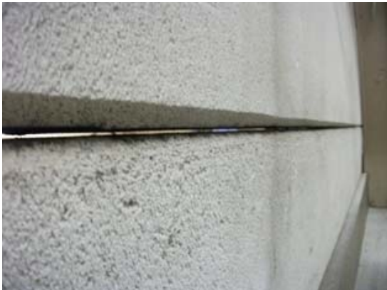
管理区域境界のALC壁繋ぎ目の隙間
