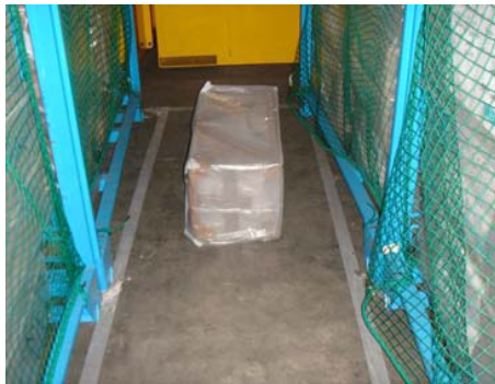
①UWSF-1 (管理区域:貯蔵庫1F) フィルタ梱包物の落下
