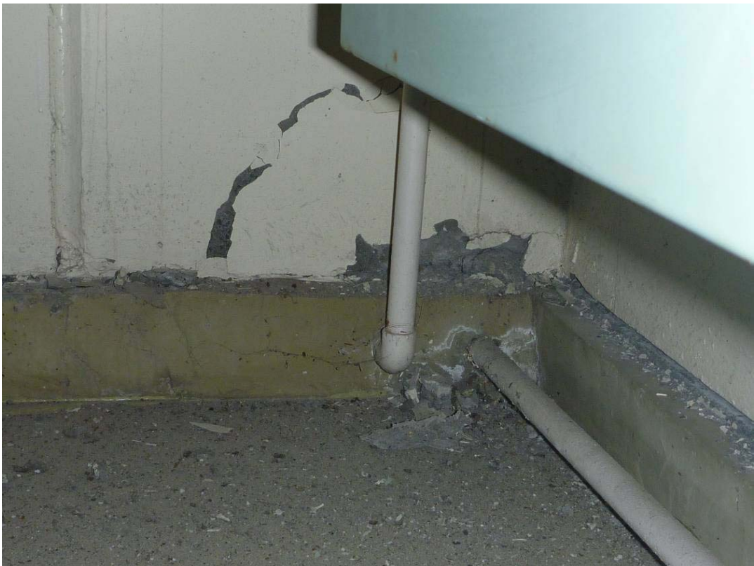
写真8 工学試験室1階（小扉横）（被害箇所⑧）
