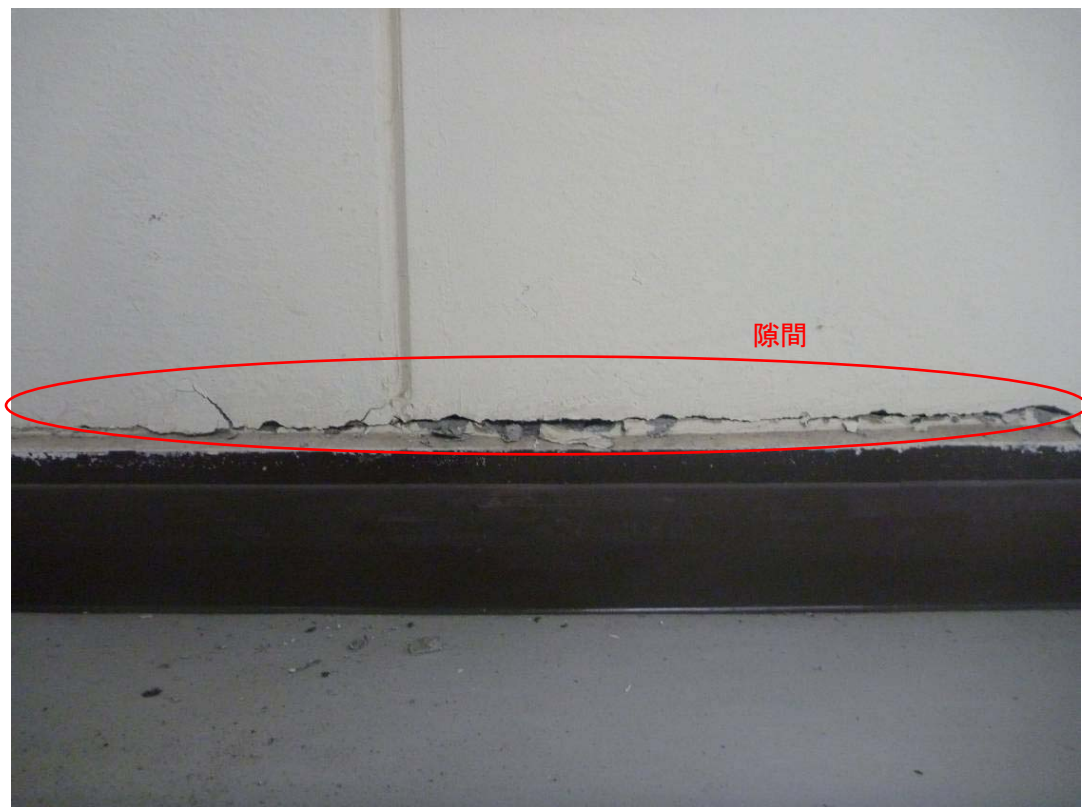
写真2 1階廊下（工学試験室側壁－床境界）（被害箇所②）
