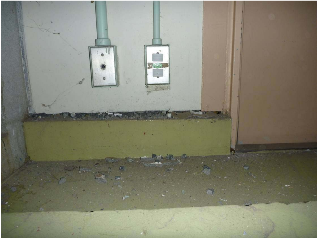
写真7 工学試験室1階（東側大扉—小扉間）（被害箇所⑦）
