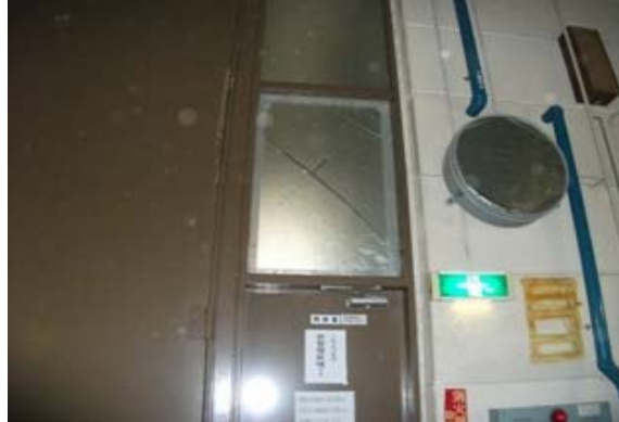
試験室(1)扉上ガラス破損 (ビニルシートによる補修後)
