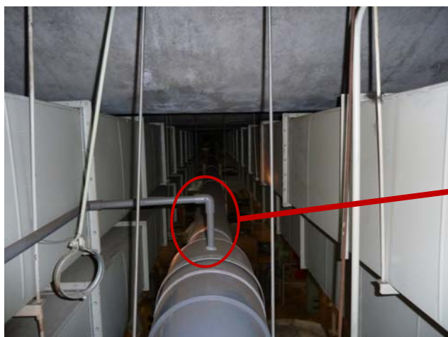
ダクト損傷部
