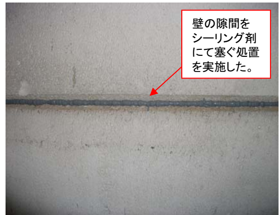
L棟排気機械室の管理区域境界 ALC板壁の隙間の処置状況
