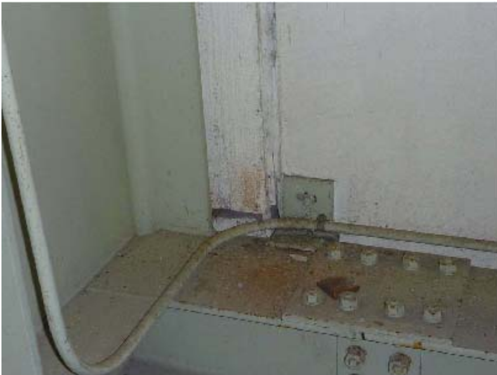
写真 10 管理機材倉庫（工学試験室側壁（北西部））（被害箇所⑩）
