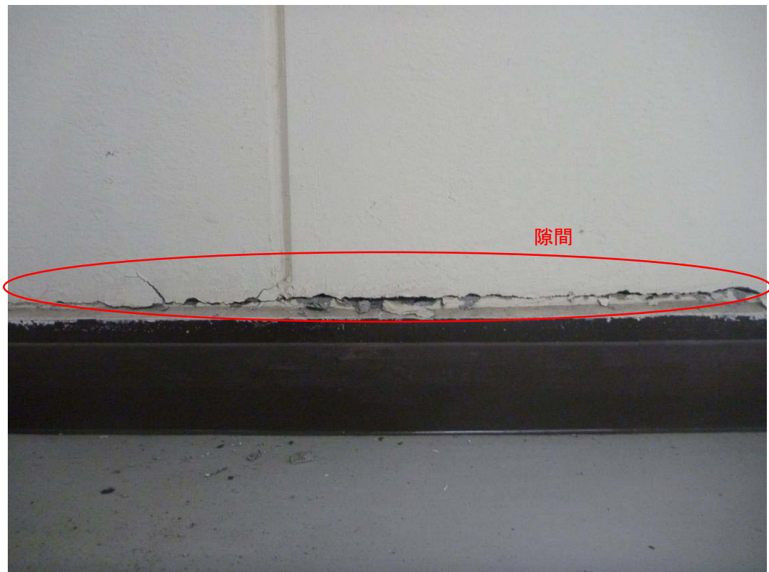
写真2 1階廊下（工学試験室側壁一床境界）（被害箇所②）
