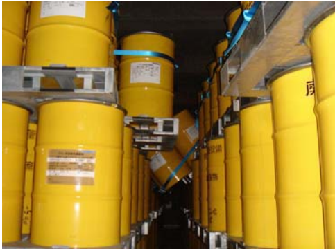
③第2UWSF-3 (管理区域) ドラム缶荷崩れ(保管室4F)
