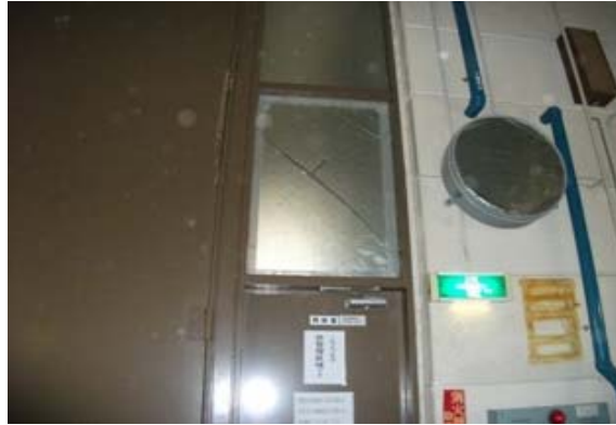
試験室(1)扉上ガラス破損 (ビニルシートによる補修後)
