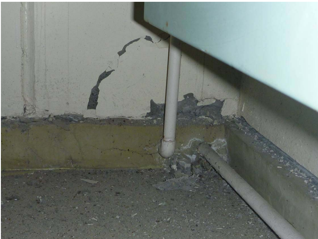
写真8 工学試験室1階（小扉横）（被害箇所⑧）
