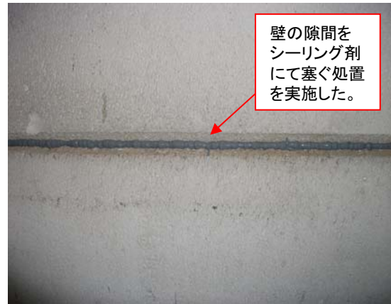
L棟排気機械室の管理区域境界 ALC板壁の隙間の処置状況
