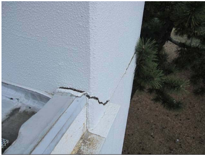
亀裂箇所（コーキング前）
