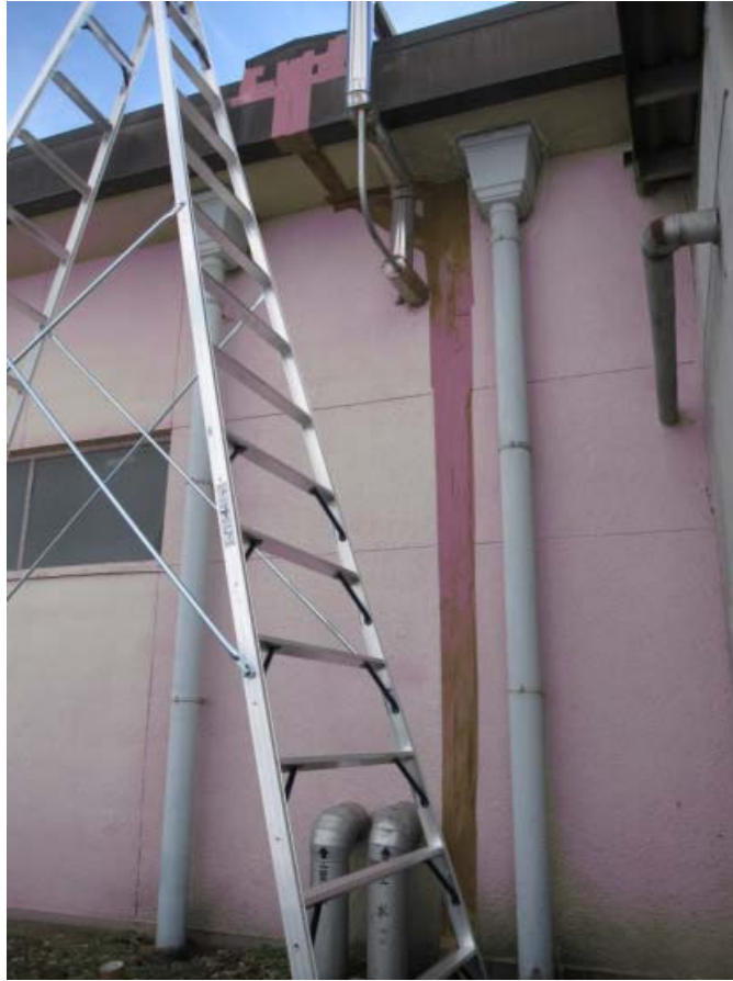
A棟-1 管理区域増設部接続部亀裂（目張り養生後）
