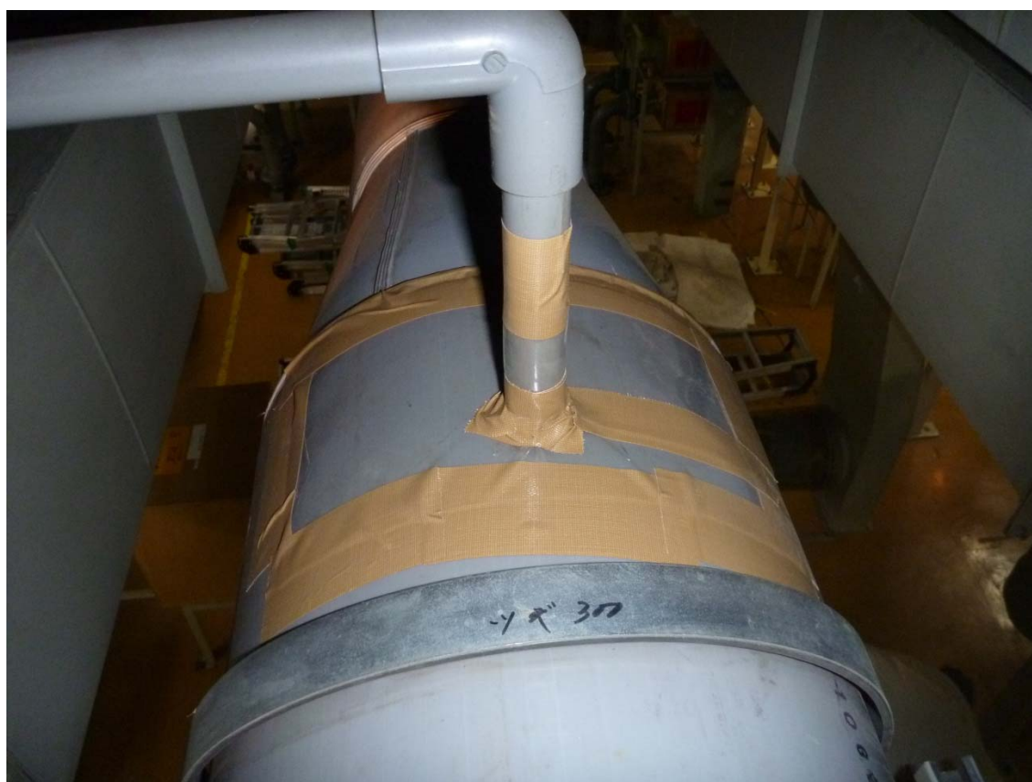
Pu-2③ GB系排気ダクト損傷部②
