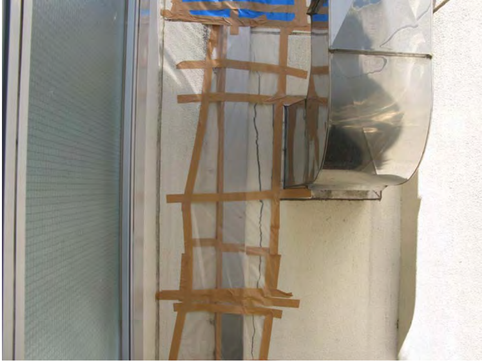
RI 製造棟の管理区域境界壁の亀裂・隙間 (通路外側から撮影。内側の通路が管理区域)
