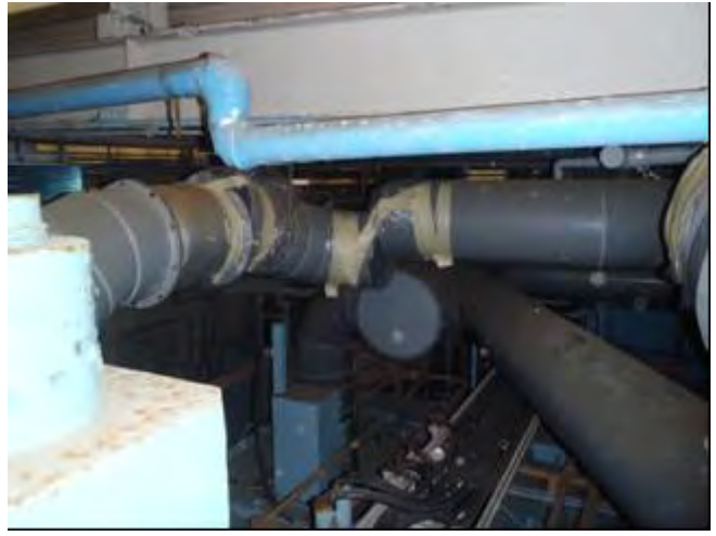
フランジ接続部の外れ
