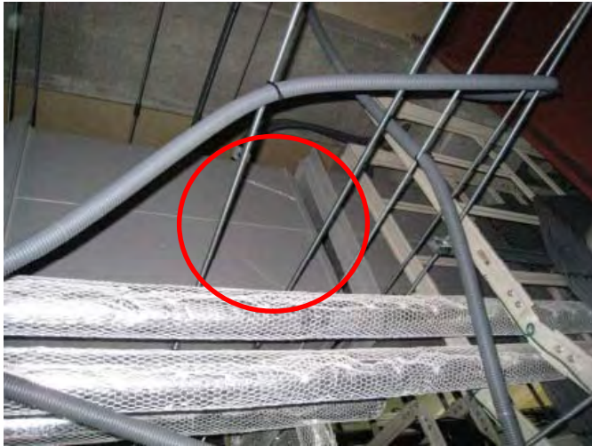
クリーンルーム排気ダクト脱落
