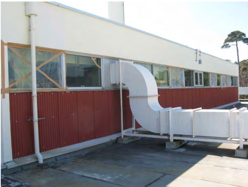
排風機室ガラス窓の破損
