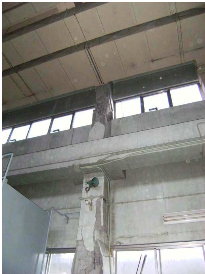
室内柱の座屈状況(上部)
