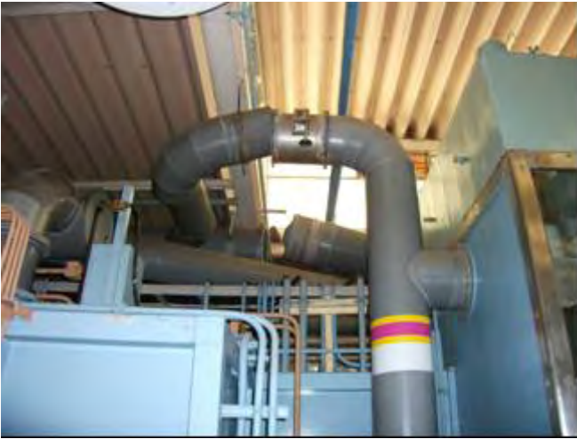
建家内の排気ダクトの脱落
