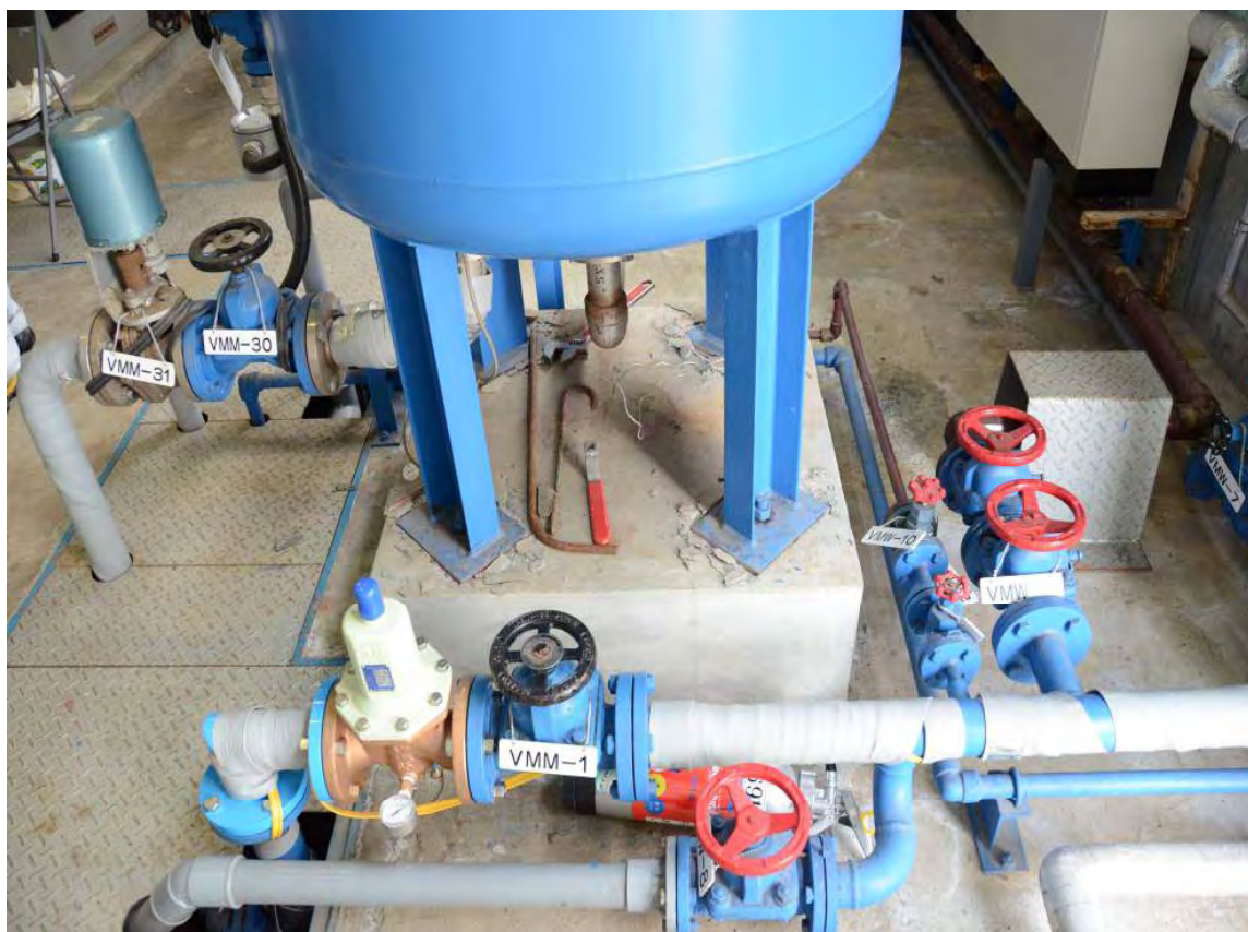
純水製造装置土台のひび
