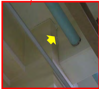
梁と柱の接合部ひび割れ
