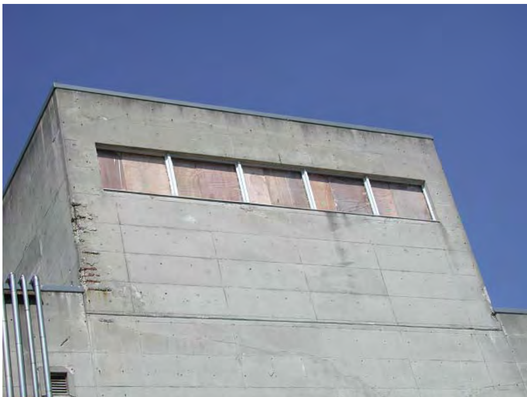
バックエンド技術開発建家 ガラス破損（応急処置後）
