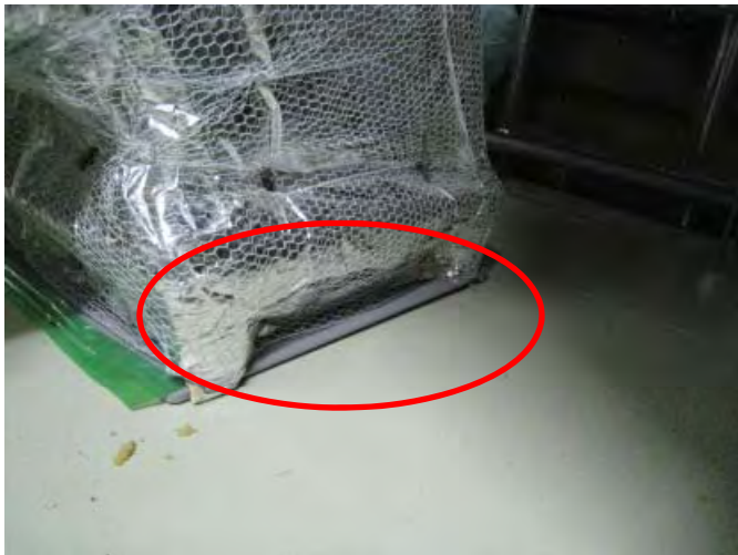
給気ダクト接合部に隙間
