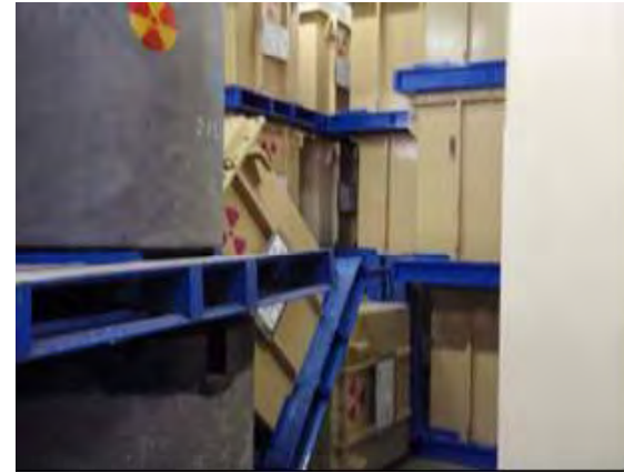
保管体の荷崩れ
