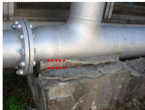
2次冷却塔周辺の地盤沈下
