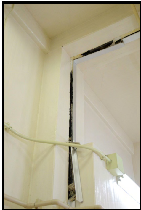
内側から見た亀裂の状況
