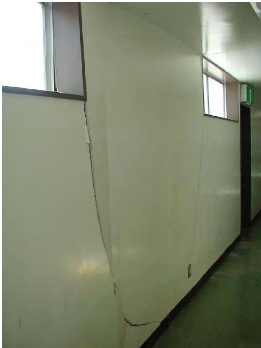
使-38 バックエンド技術開発建家 壁等の亀裂
