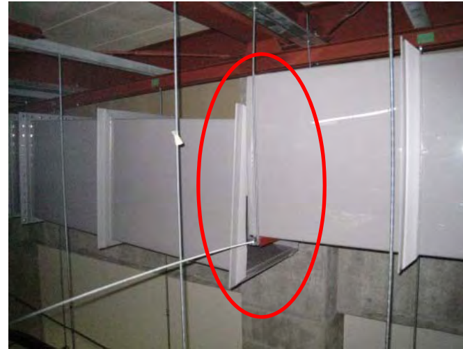
クリーンルーム排気ダクト脱落
