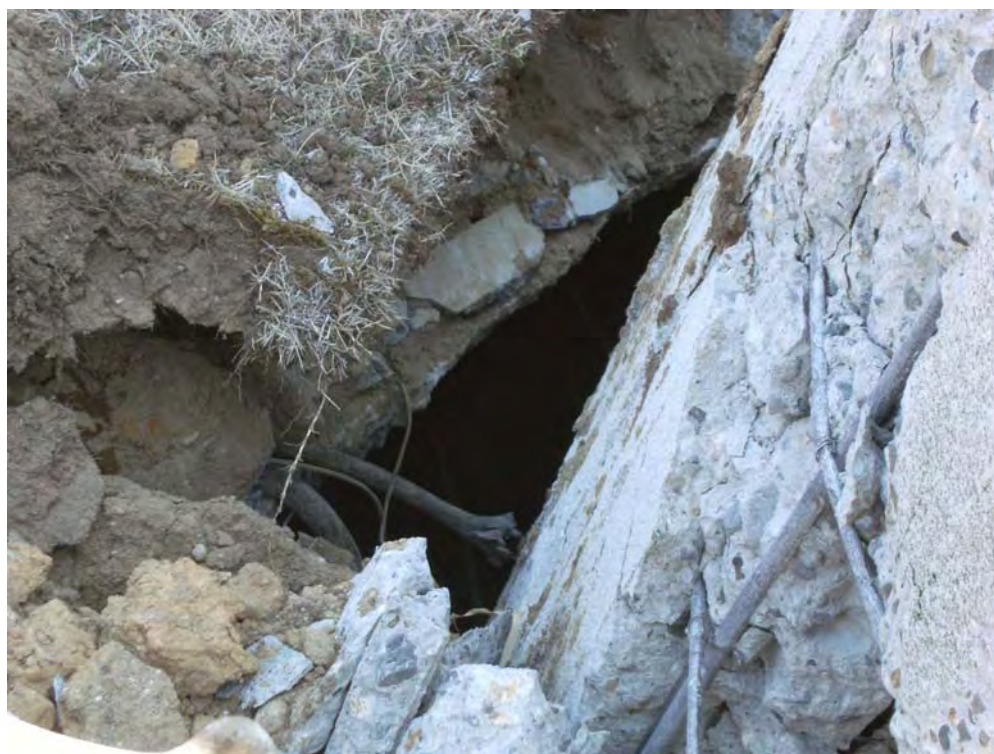
コンクリートダクトの損壊状況
