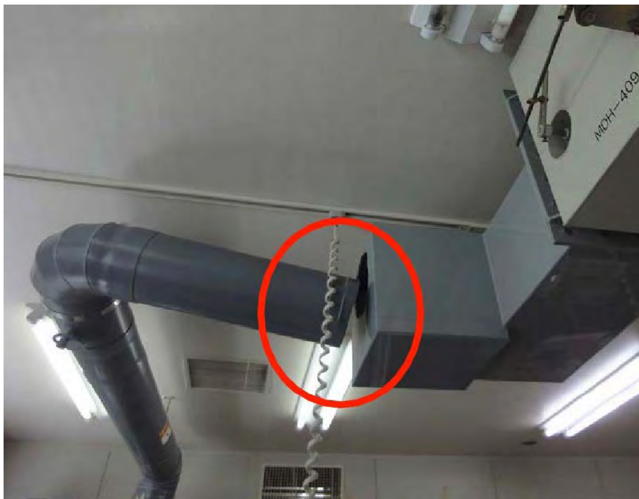
使-25 第4研究棟 排気ダクトの破損(409BC)
