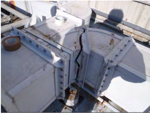
屋外ダクトの破損箇所
