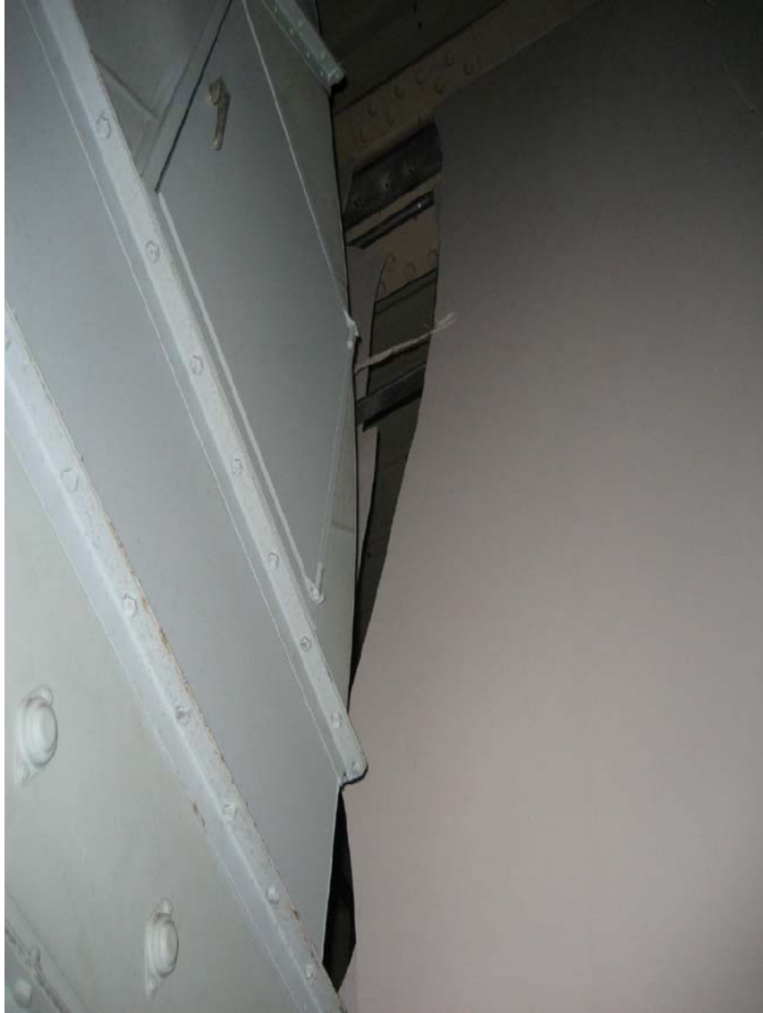
東機械棟管理区域境界の壁の破損
