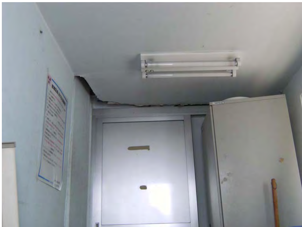
放射性廃液貯槽室の損傷
