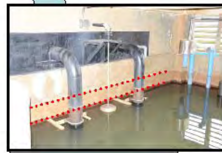
No.1水槽水位降下
