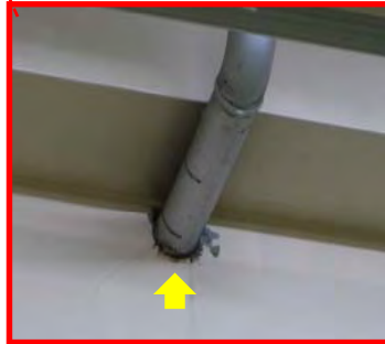
蒸気戻り配管壁貫通部の壁ひび割れ
