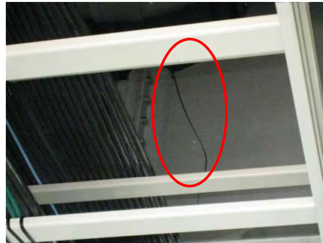
クリーンルーム排気ダクトひび割れ
