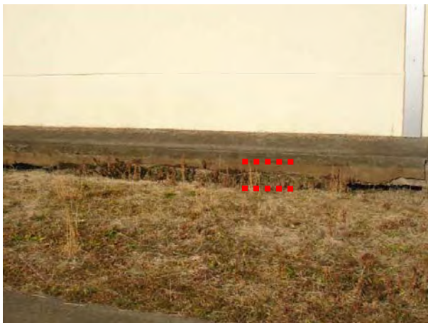
原子炉建家周辺の地盤沈下
