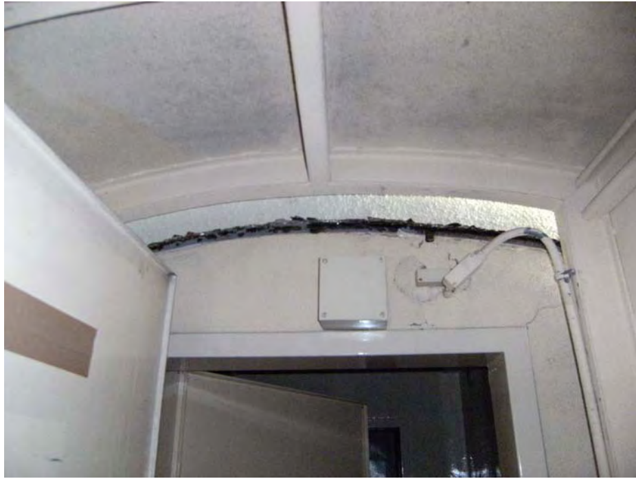
燃料貯蔵庫の損傷
