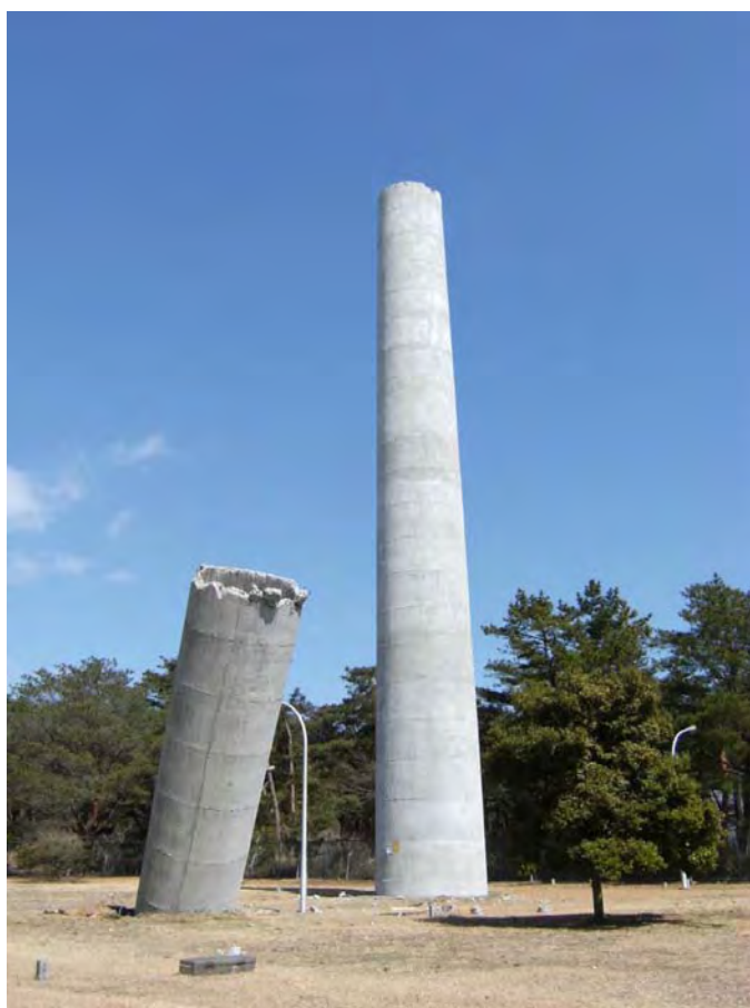
排気筒の損壊状況
