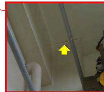
柱の天井接合部ひび割れ
