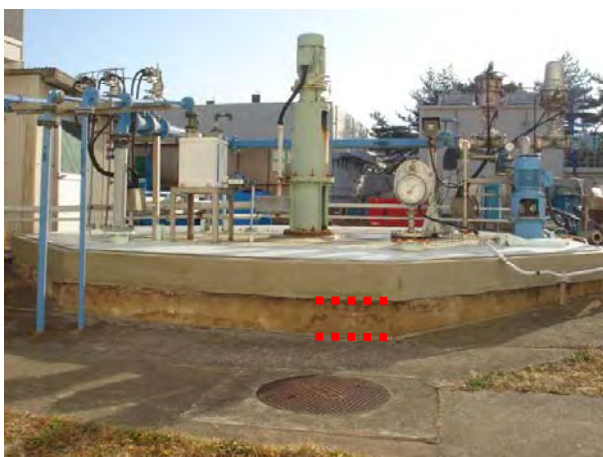
廃液中和槽周辺の地盤沈下
