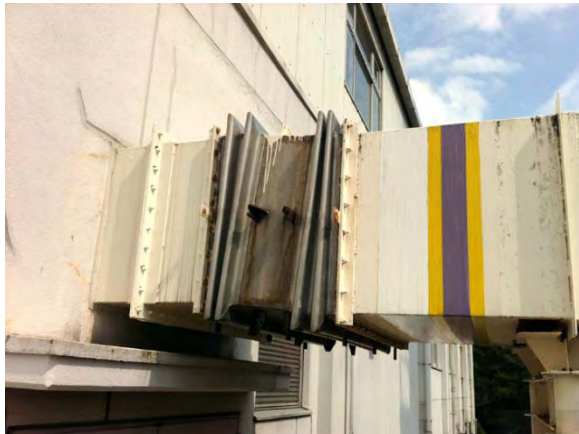
TPL排気塔への主排気ダクトのベローズ変形
