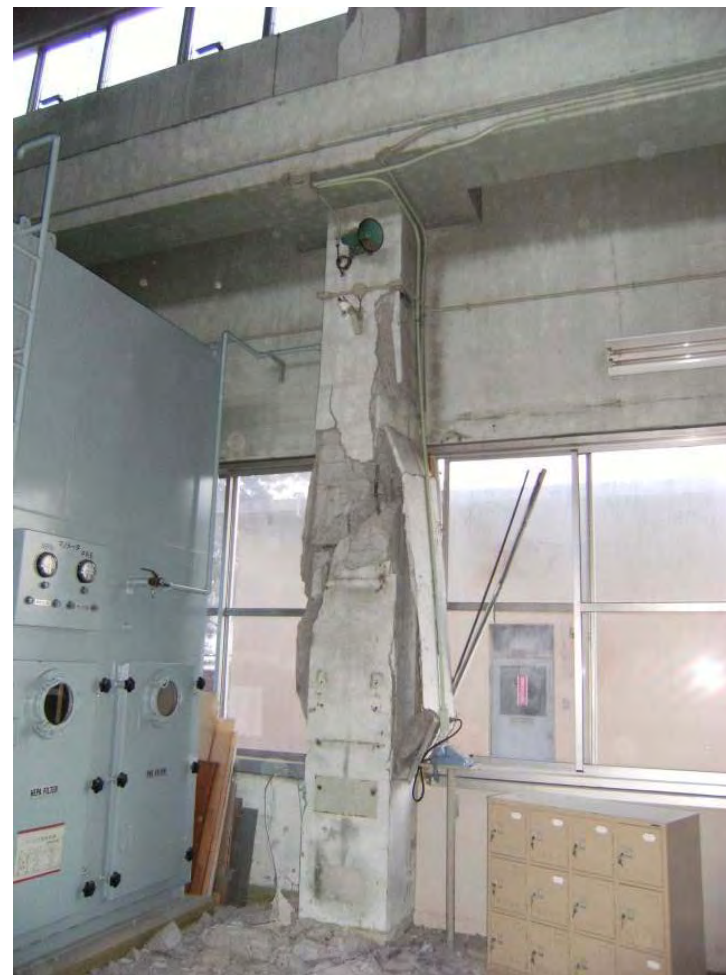
室内柱の座屈状況(下部)
