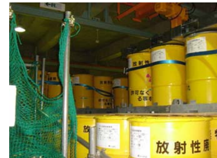
荷崩れドラム缶の取出し後
