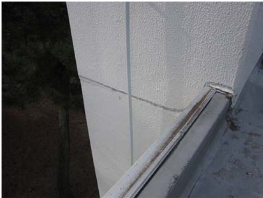
コーキング後の亀裂箇所(北側)
