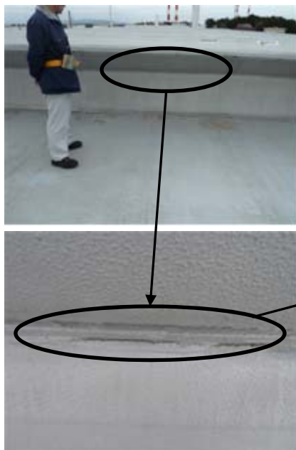
屋外から見た隙間箇所 (最大 長さ5mm、幅1mm程度)
