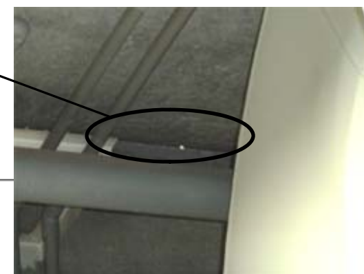
フィルタ室側から見た隙間箇所
