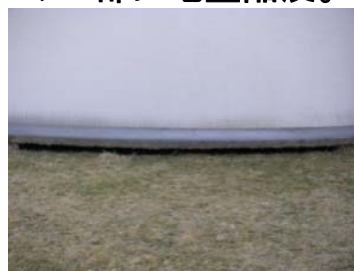
原子炉建家廻の地盤陥没の状況
