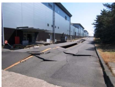
リニアック棟横の構内道路の状況
