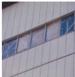
応急措置を行った窓
