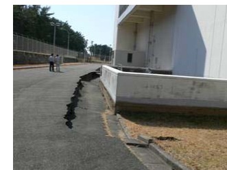
NUCEF周辺に生じた地盤陥没の状況
