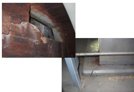
ボイラ内側の耐火煉瓦の剥離 ボイラ土台の割れ
