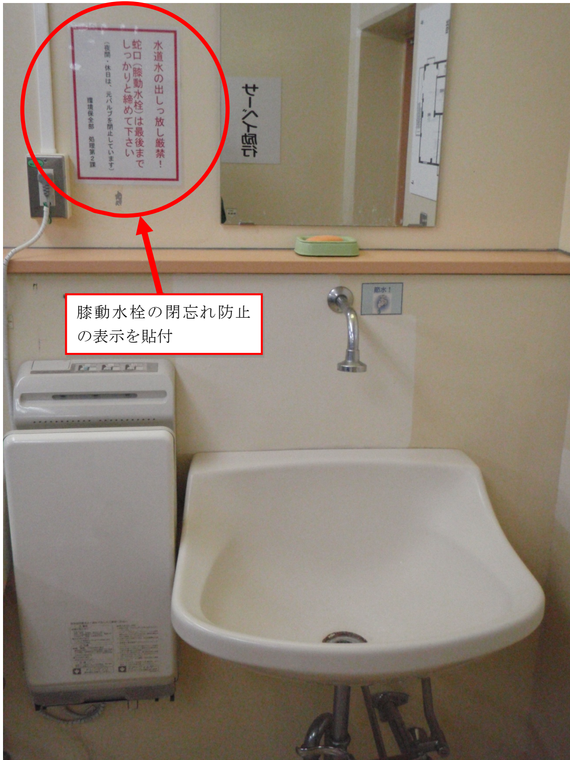
写真-1 膝動水栓の閉め忘れ防止の表示
