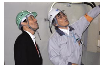
2次主冷却系配管室ご視察
