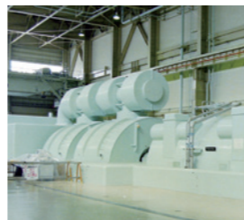
タービン発電機
