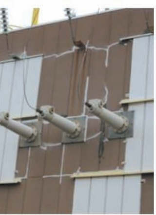
●損傷した南変電所(左)。応急措置を行い給電再開(右)
