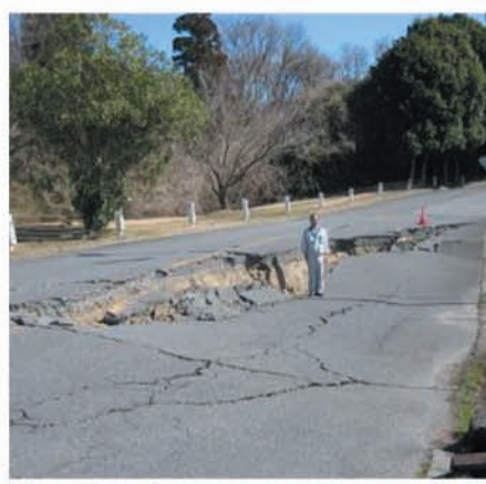
●所内アクセス道路 約20mにわたり大きな地割れ、1mの陥没。
