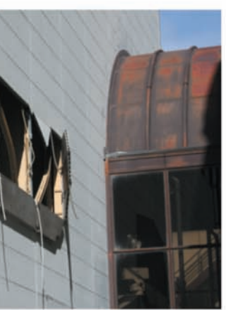
●那珂核融合研究所 実験準備棟の外壁落下
