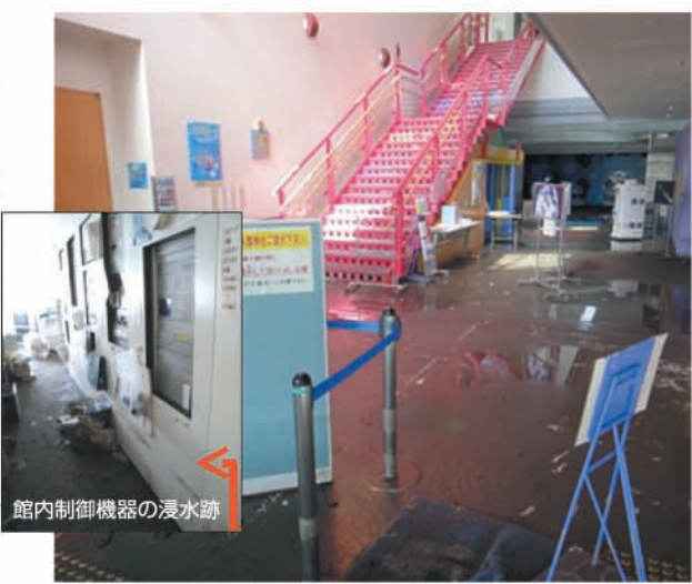
●大洗わくわく科学館 津波により一部損傷
