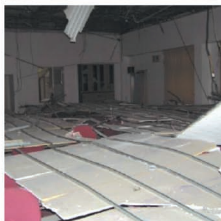
●JRR-1 (廃止措置済み) 講義室の天井が落下
