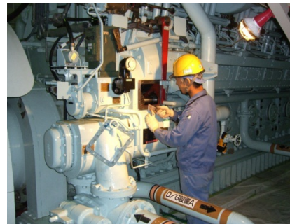
【非常用ディーゼル発電機設備(A系)点検】 (撮影日 平成24年12月13日)
