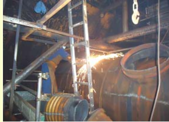
【復水器第1.2給水加熱器(※1) 胴部外装板切断作業(復水器内部)】 (撮影日 平成24年10月4日)
