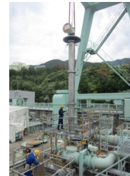
【補機冷却海水系ポンプ分解点検】 (撮影日 平成24年9月8日)
