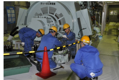
【非常用ディーゼル発電機(B系)点検】 (撮影日 平成24年8月21日)
