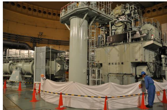
【燃料交換装置と燃料出入機】
