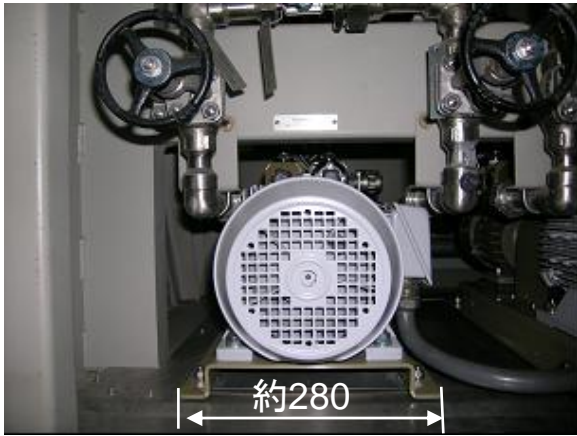
ラック正面から見たブロウ
