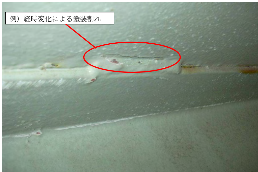
写真 4-1 すみ肉溶接部における塗装の劣化例
