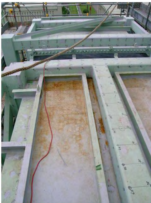
写真 1.1 ダクト上面における溜り水の様相
