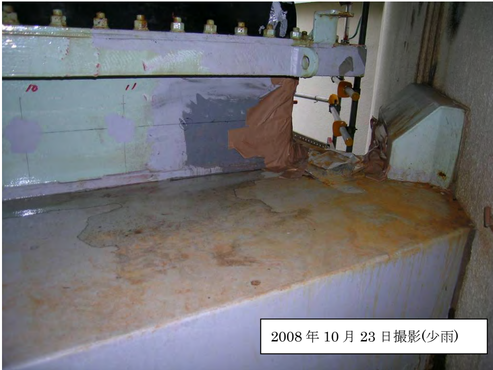
写真 3-3 2 か所目近傍のレインフード上の雨水の溜り状況
