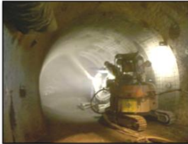
図 2-4 低アルカリ性コンクリート材料による坑道吹付け施工技術の実証 (幌延深地層研究センター深度 140m 調査坑道での施工例)
