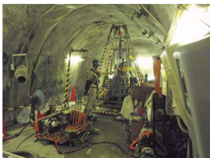
応力計の設置 (深度 300m 研究アクセス坑道 11m 計測横坑)
