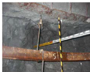
図2 抜け落ち箇所 (深度147m, 奥行き1.2m)
