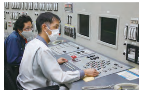
運転中の制御室の様子
