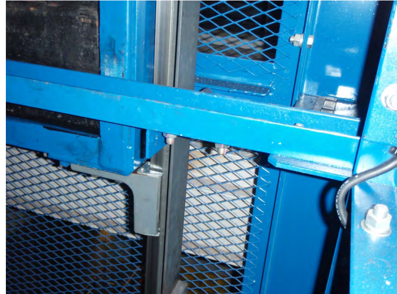
垂直搬送機カウンタウエイトの脱線(復旧後) (H23.10.14)
