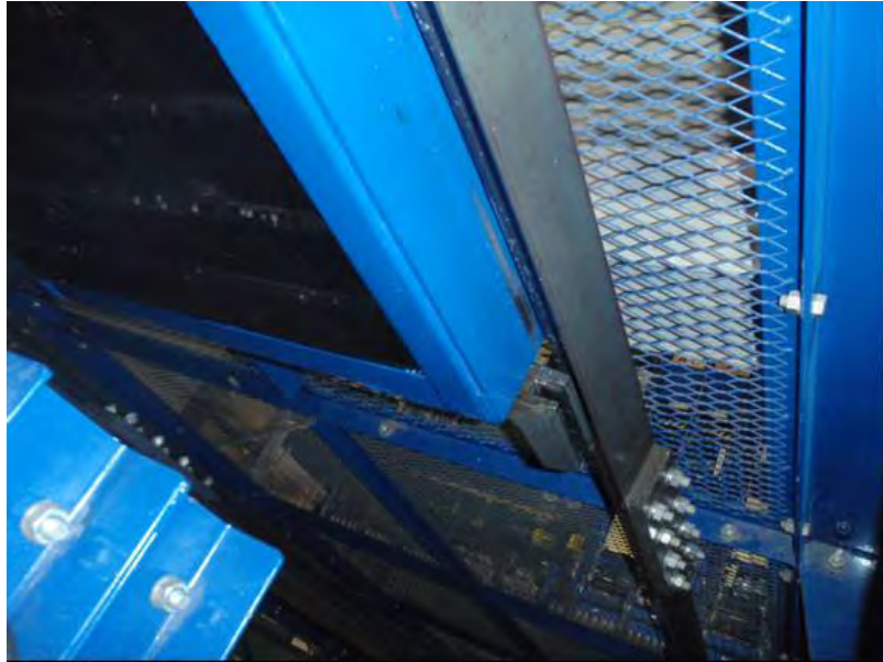
垂直搬送機カウンタウエイトの脱線(復旧前)
