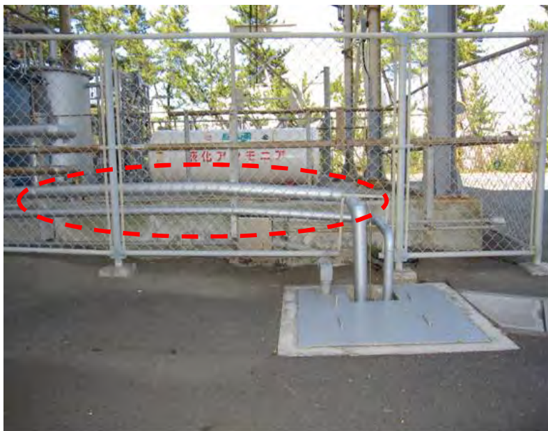
LPG配管の変形(復旧前)
