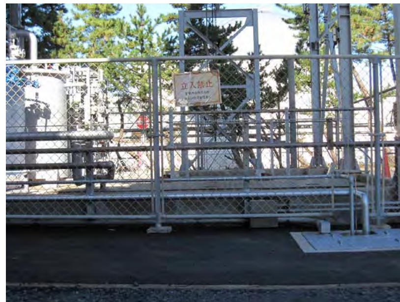
LPG配管の変形(復旧後) (H23.12.7)
