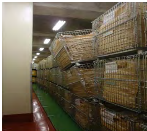
ボックスパレットの変形（復旧前）
