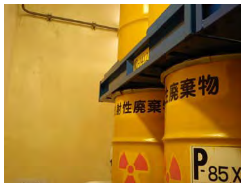
保管体の荷崩れ（復旧後）
