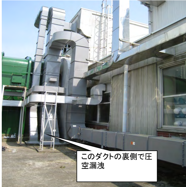
トラック扉外側で圧空漏洩(非管理区域)
