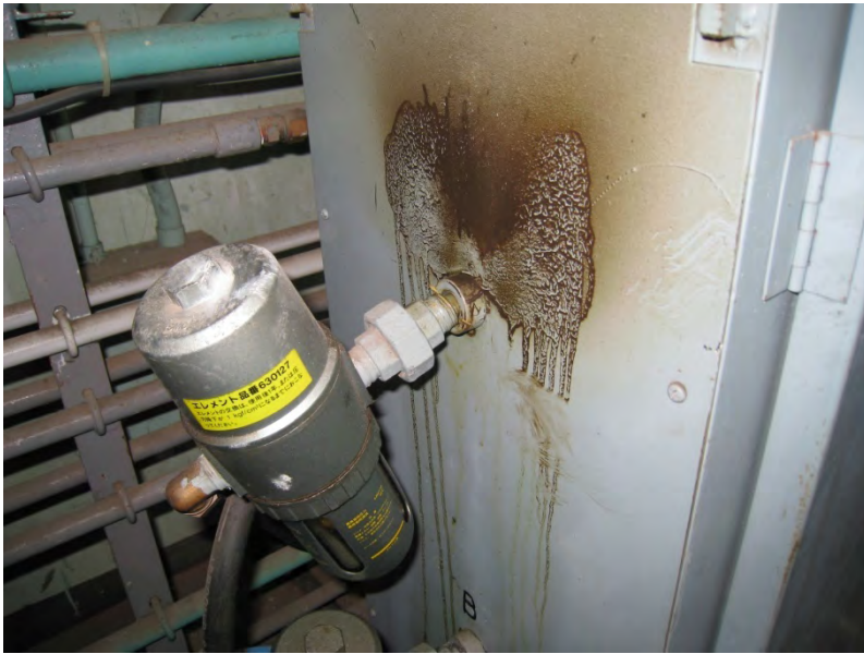
破損箇所(処置前)
