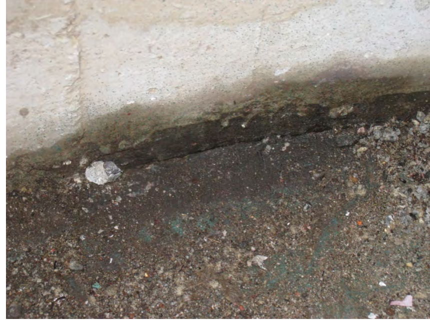
圧空漏洩箇所 (埋設配管のため、詳細な漏洩箇所は不明)
