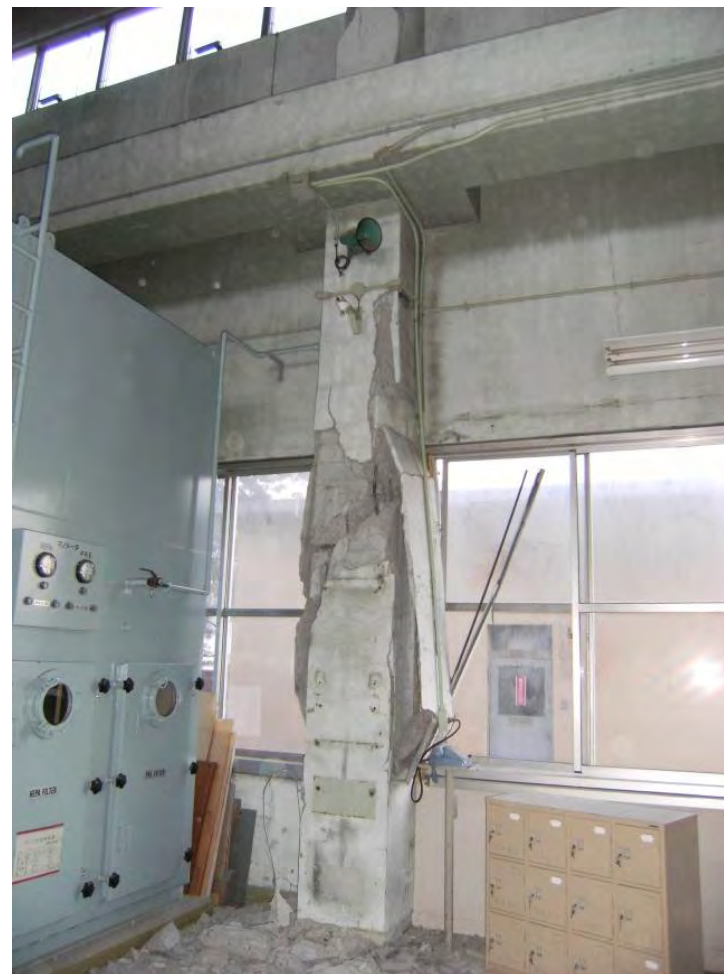
室内柱の座屈状況(下部)
