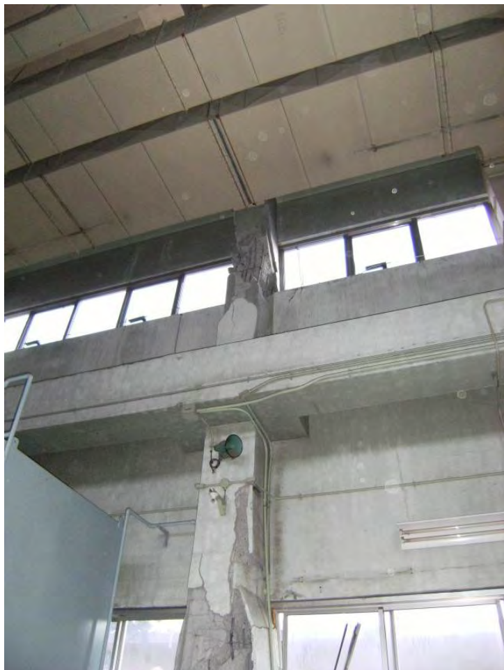
室内柱の座屈状況(上部)
