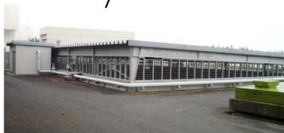
排水貯留ポンド
