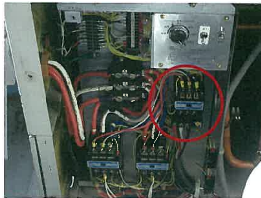
パッケージエアコン内部の状況 (火災前) (2006年7月撮影)
