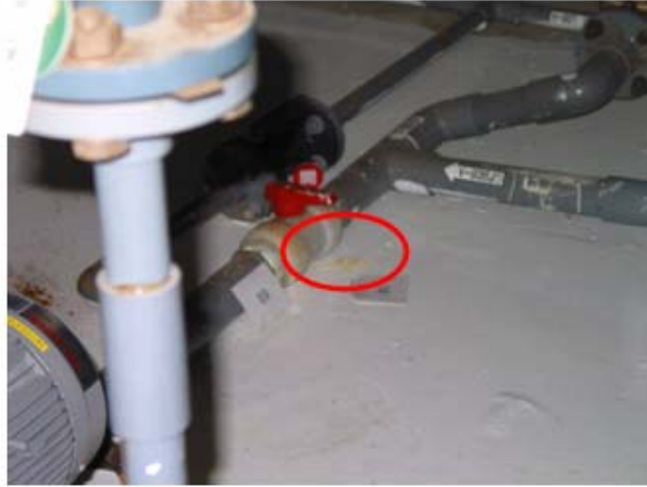
写真-1 廃液処理室(1)の漏えい痕せき・固着物 1 (図-2(1)のA部)
