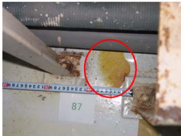
写真-2 廃液処理室(1)の漏えい痕せき・固着物 2 (図-2(1)のB部)
